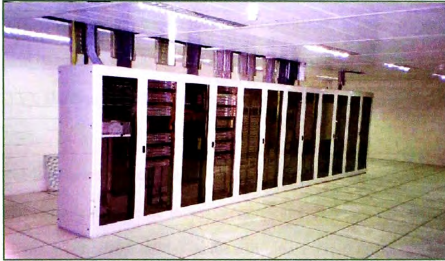
Fig.2.2 Sala de equipos de comunicación
