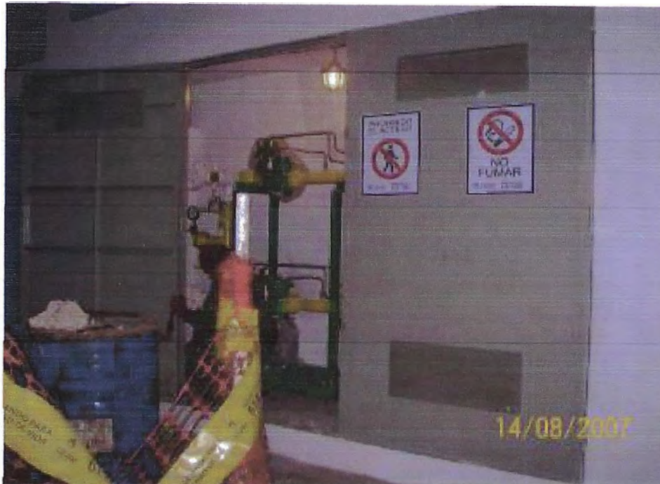
Foto N° 3 Vista panorámica de la caseta de ERMP
