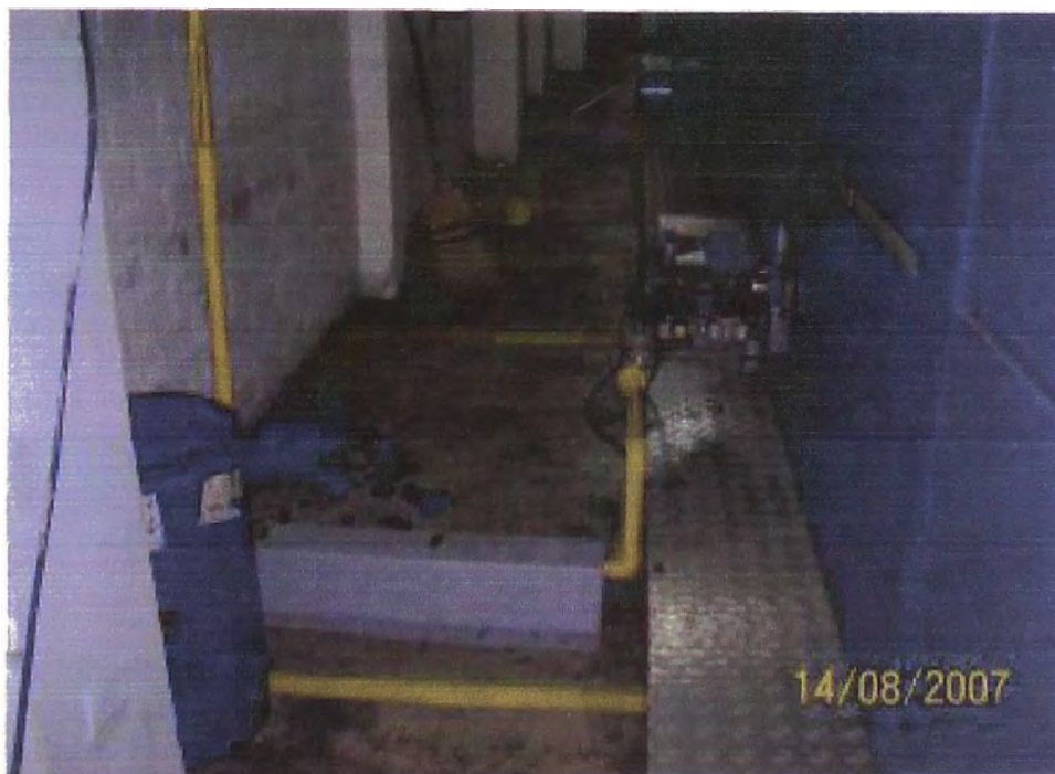
Foto N° 10 Ingreso de línea a quemadores
