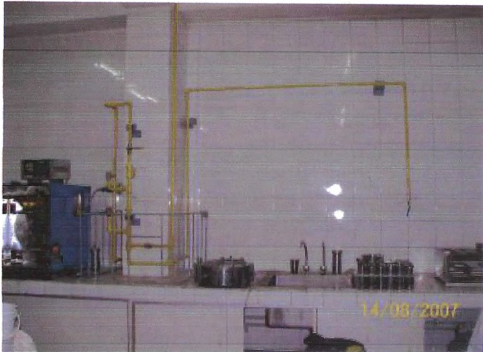
Foto N° 11 Línea de Ingreso y ERS - Cocina
