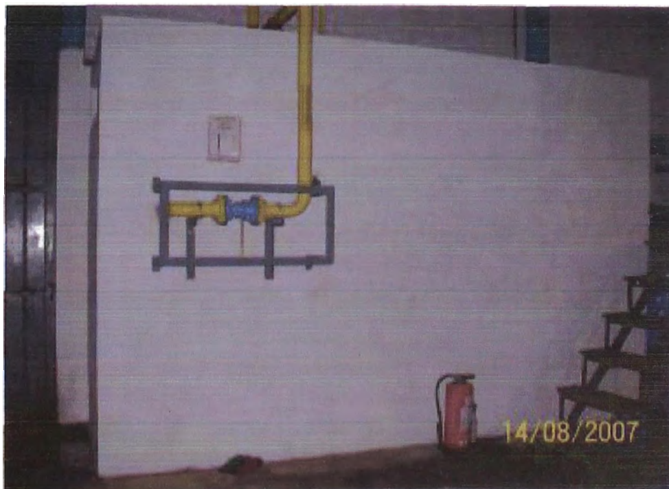
Foto N° 4 Válvula de corte general – Interior de la planta
