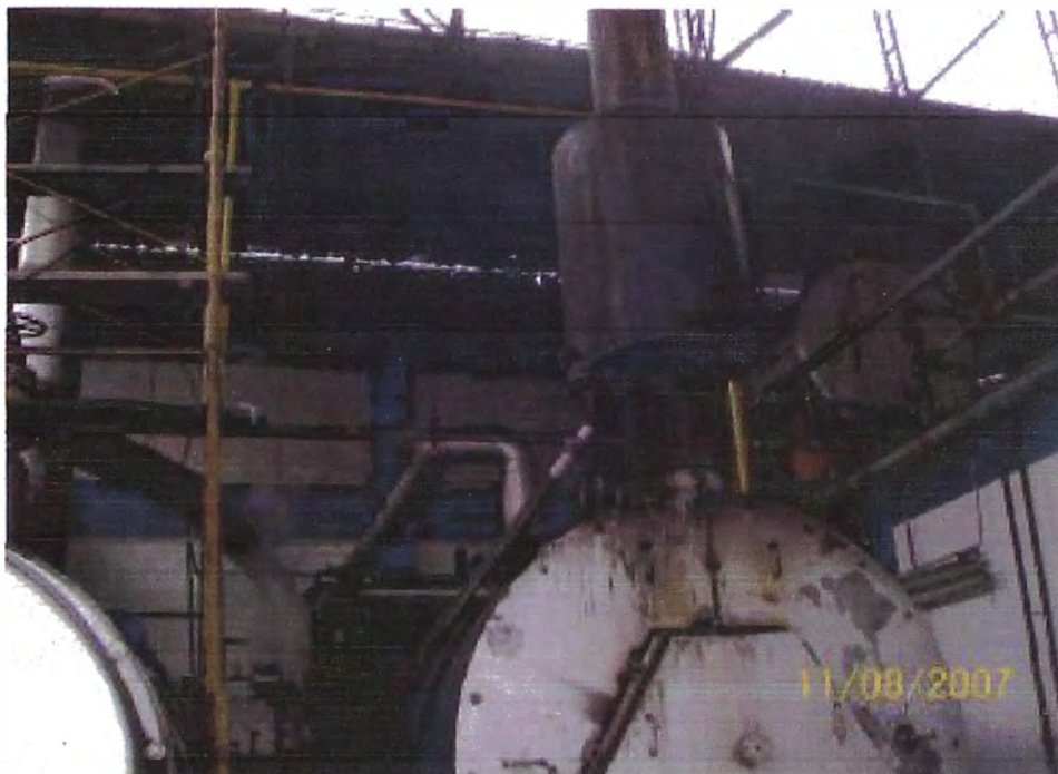
Foto N° 7 Vista general de instalación - Calderos
