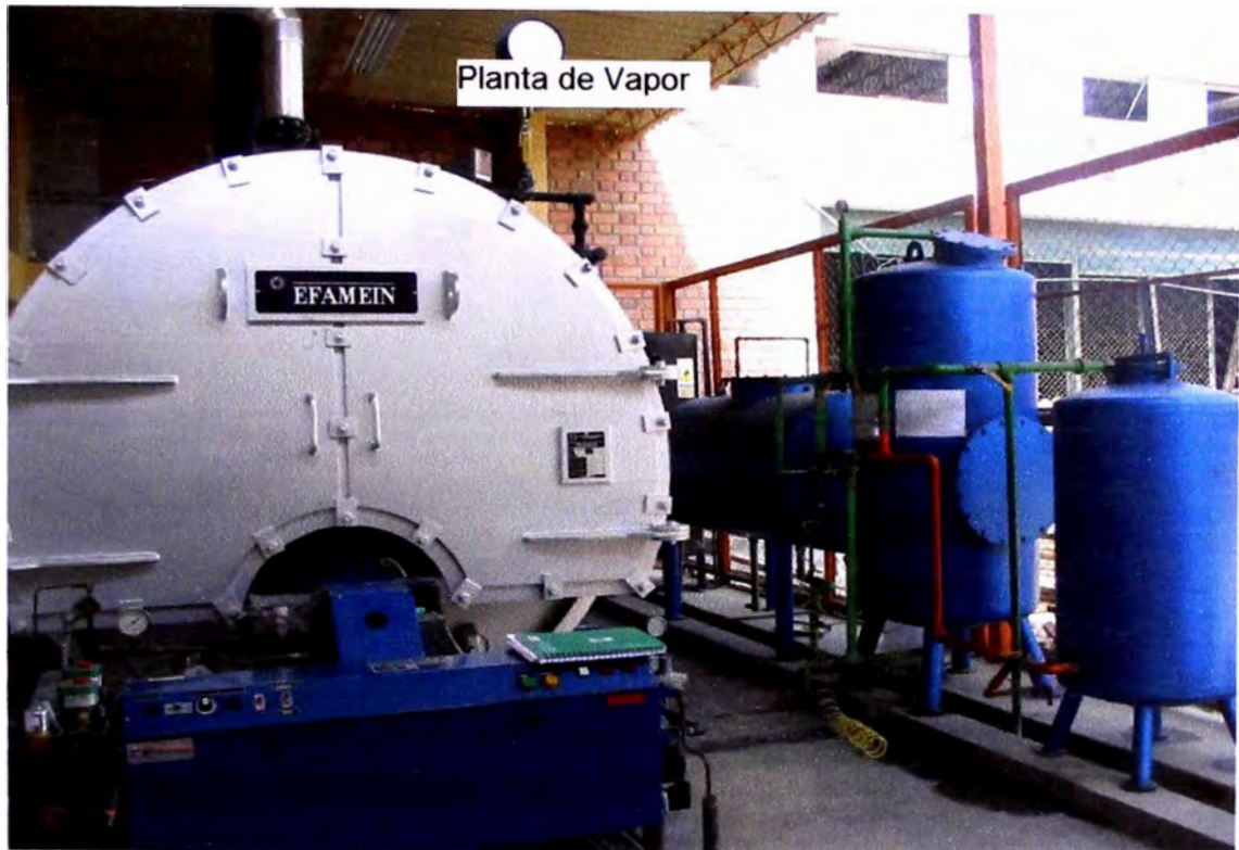
Figura 4.1: Sistema de Generación de Vapor
