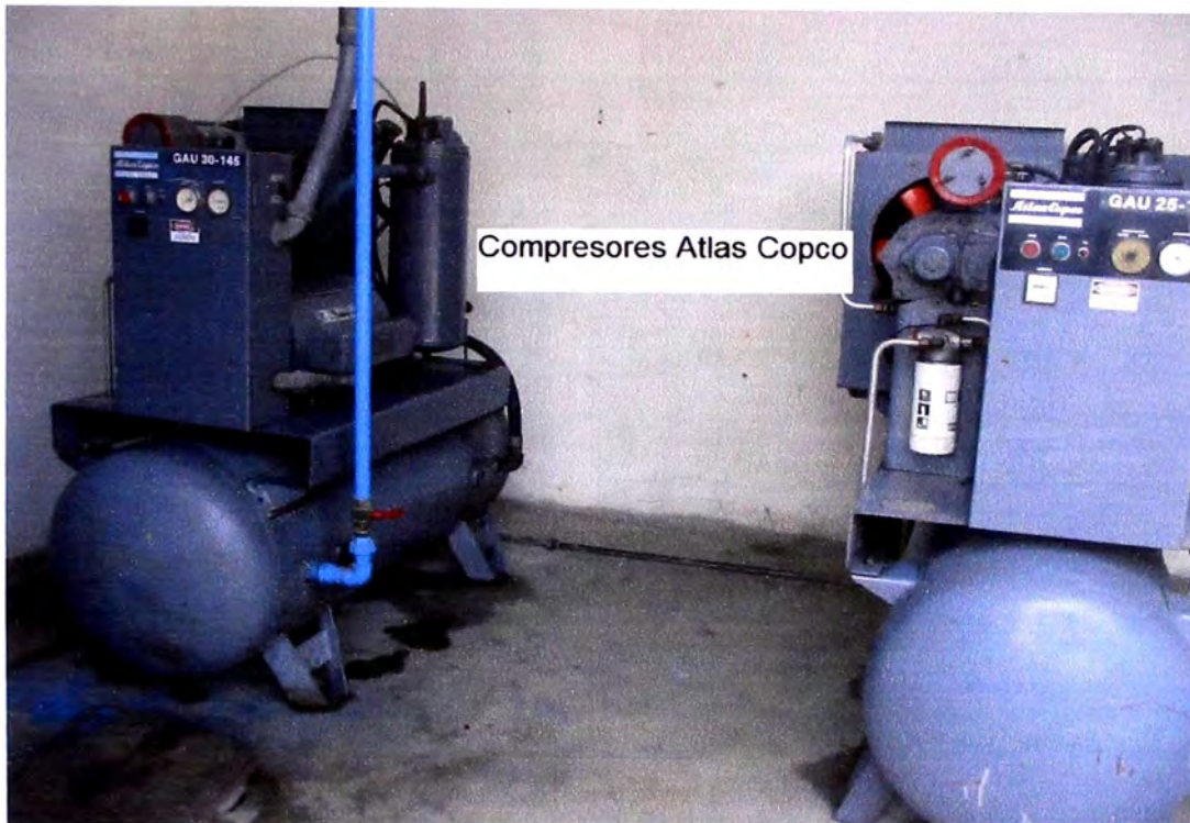
Figura 4.4: Sistema de Compresión de Aire
