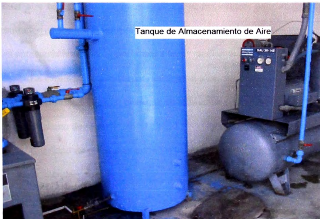
Figura 4.5: Almacenamiento de Aire
