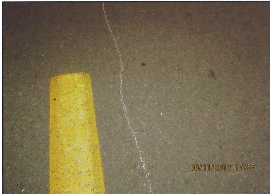
Fisura Longitudinal de Severidad Baja menor de 3mm
