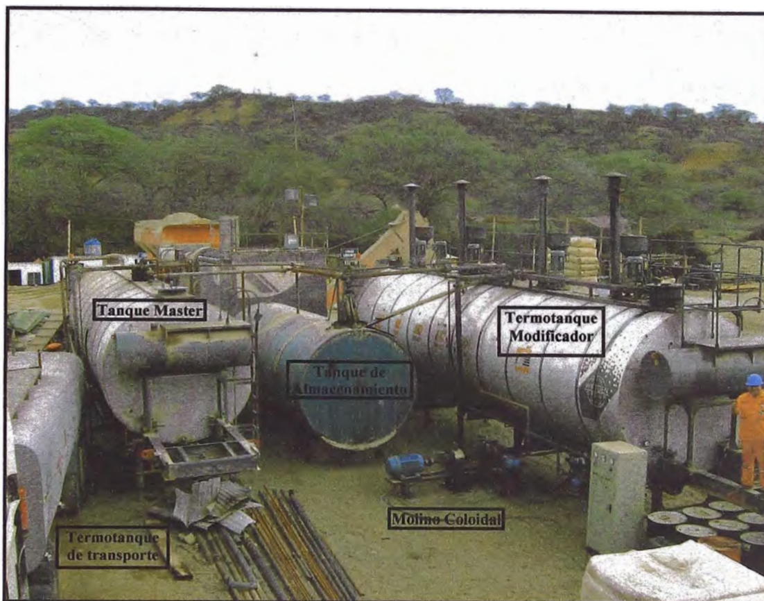
Foto 21: Vista del sistema de funcionamiento de la planta de modificación de cemento Asfáltico
