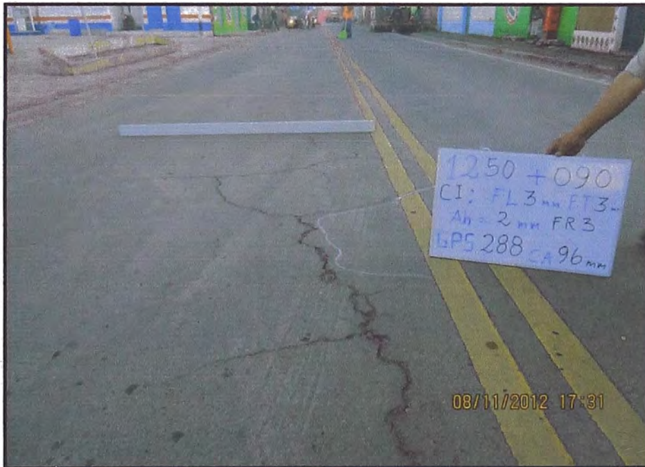
Fisura Longitudinal de Severidad Media de 3mm a 13mm
