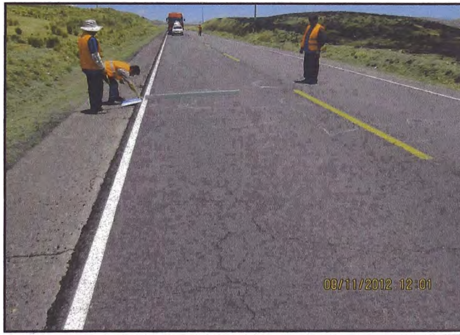
Fisura Piel de Cocodrilo de Severidad Baja menor de 3mm
