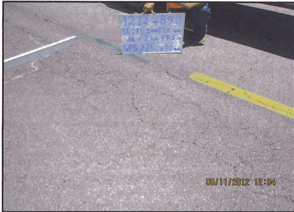
Fisura Piel de Cocodrilo de Severidad Baja menor de 3mm
