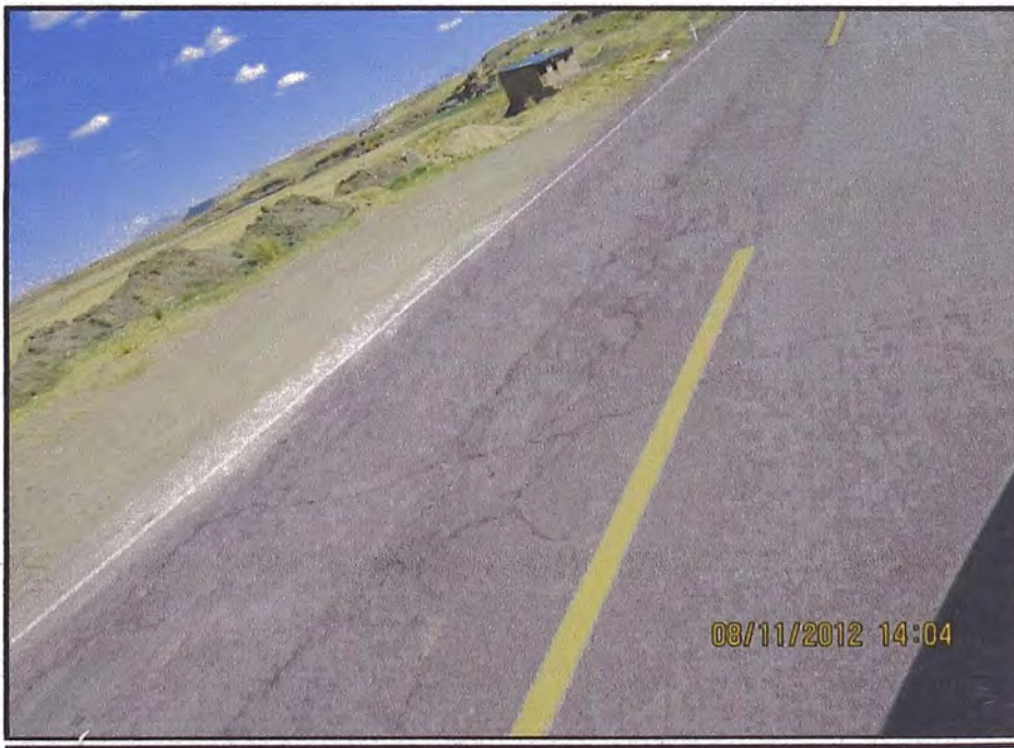
Fisura Ramificada de Severidad Baja menor de 3mm
