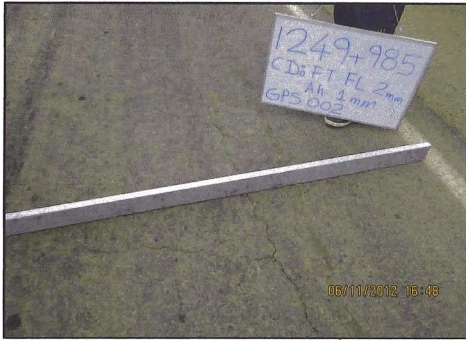
Fisura Longitudinal de Severidad Baja menor de 3mm
