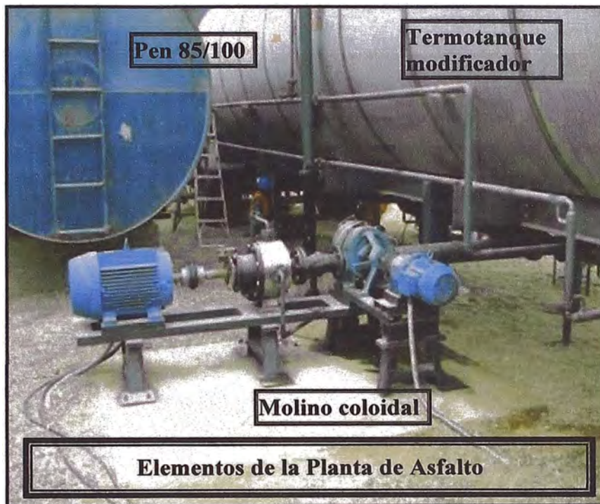
Foto 19: Equipos de planta de modificación de asfalto
