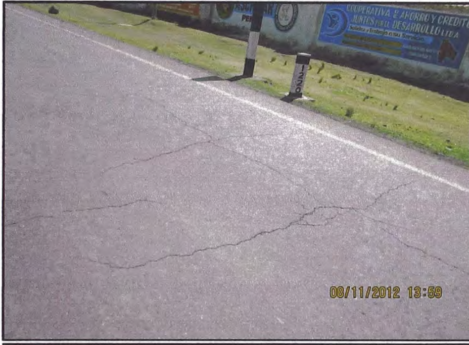
Fisura Transversal de Severidad Media de 3mm a 13mm
