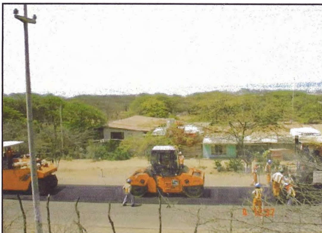
Foto 37: Vista lateral, cercanía entre los tres equipos del tren de asfalto Fuente: Elaboración propia
