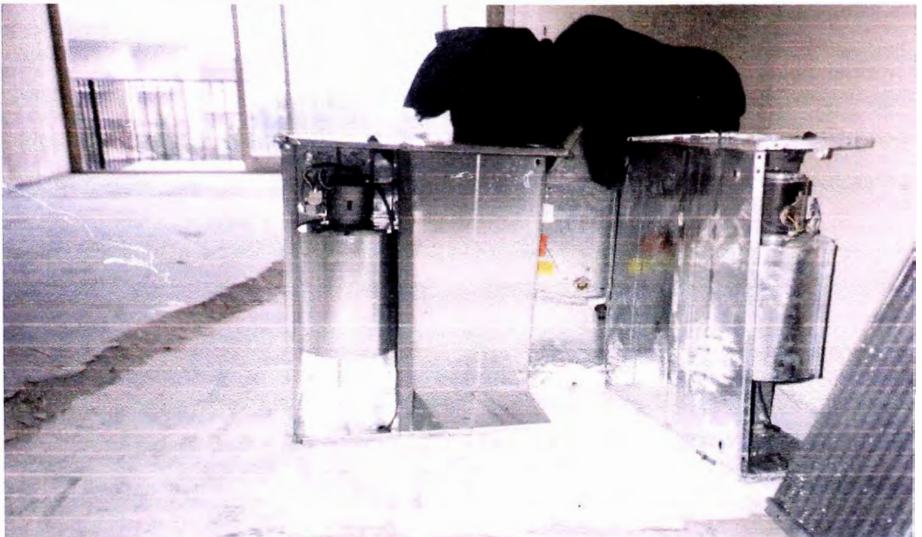
F.10. Equipo ventilador Serpentin - Motor – Ventilador SIROCCO y panel aleteado con serpentín.
