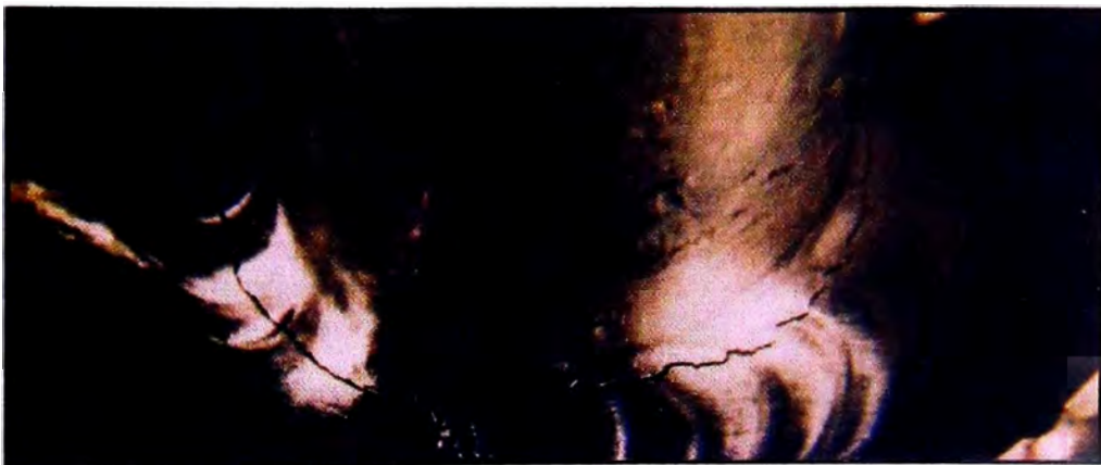
Fig. 105. Fisura Longitudinal propagada a partir de una fisura de cráter
