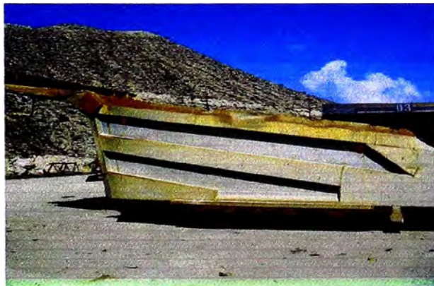
Fig. 7.3 Canal lateral Izquierdo deteriorado
