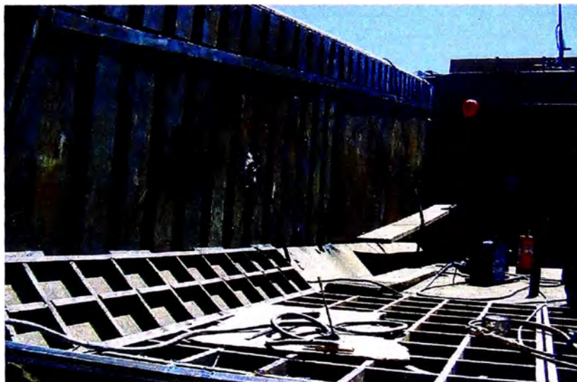
Fig. 7.17 Instalación de platinas antidesgaste, estos sirven para proteger el material base de la abrasión.
