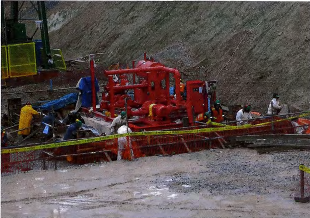
Figura N° 3.13.-235-CC14-P-IDT-003-Skid de Bomba área 235.
