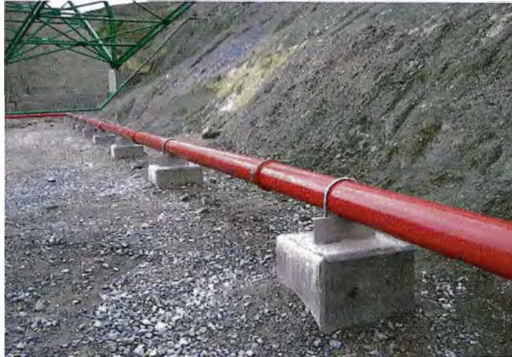
Figura N° 3.11.-245-CC14-P-IDT-003-Inclusion de plantas de Acero en la soportería del sistema Motriz Faja 626.
