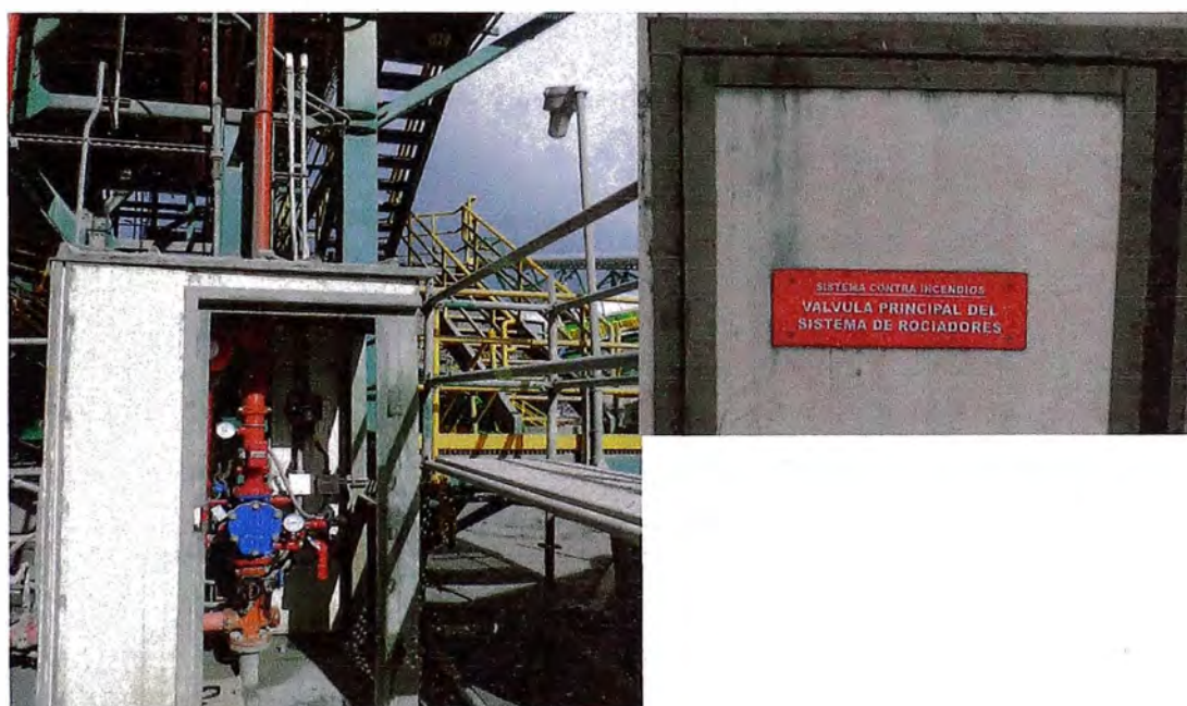
Figura N° 3.11.-235-CC14-P-IDT-002-Caseta de Válvula.
