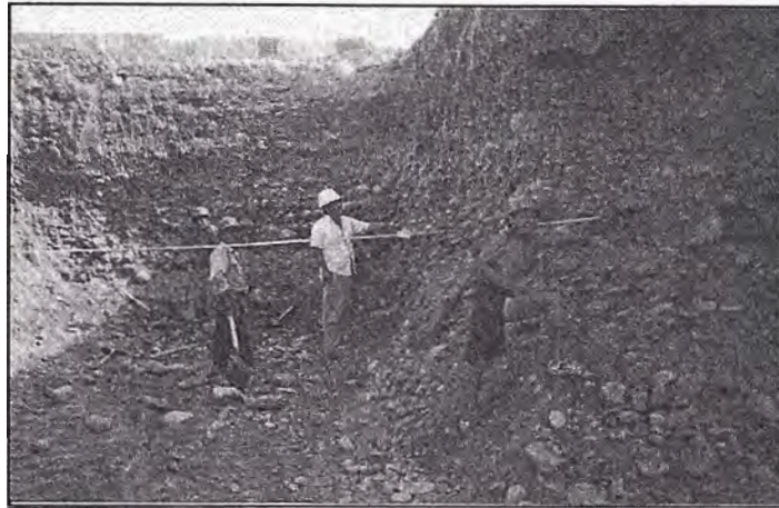
Figura N°5.5 No cuenta con señalización, ni barreras de peligro, el personal no cuenta con el EPI mínimo.
