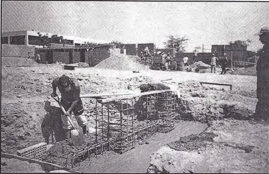
Figura N° 5.17 Se efectuó a su llenado de la zapata con concreto preparado en obra, teniendo el cuidado de tener la proporción en volumen del concreto 210 kg/cm 2
