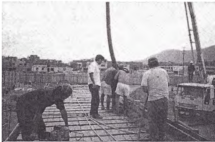
Figura N° 5.6 El personal y el responsable de obra no cuenta con el EPI y tampoco la protección colectiva.
