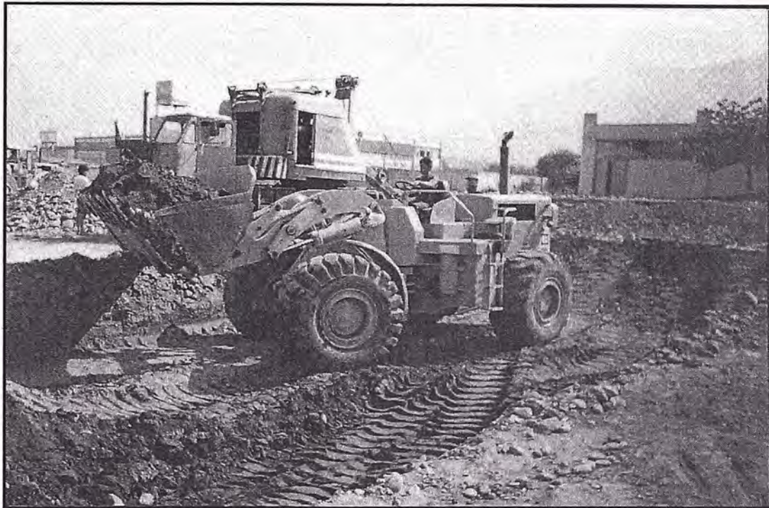
Figura N° 5.10 Se comenzó realizar una rampa para continuar la excavación en la zona de tanques, esto es para que entre el cargador frontal para perfilar las paredes y nivelar el fondo de la posa.
