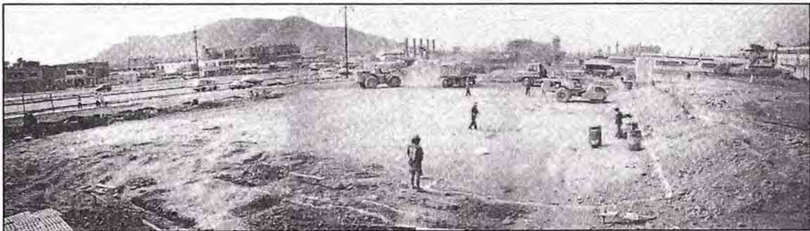
Figura N°5.3 Falta de señalización y vías de circulación de maquinarias
