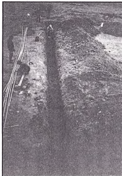
Figura N° 5.20 Después de realizar la zanja se compacta el fondo para luego colocar la cama de arena. Mientras el personal va embonando las tuberías de PVC-P
