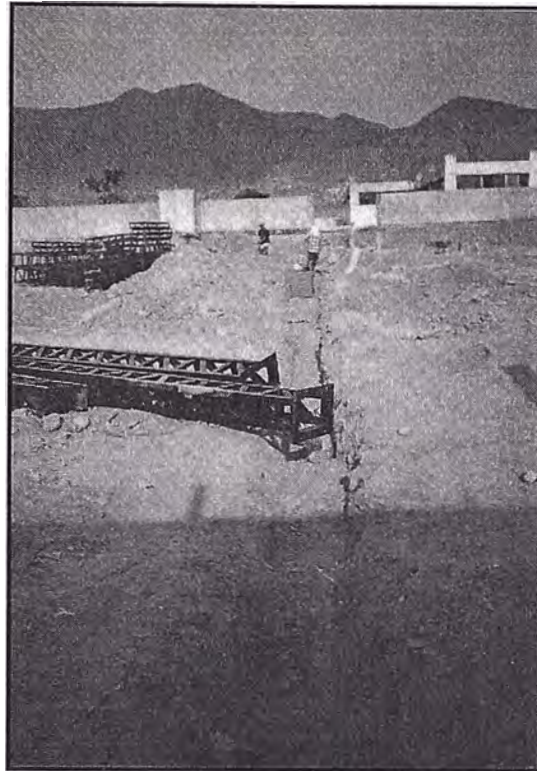
Figura N° 5.19 Se realizan las zanjas para el tendido de tuberías eléctricas. Además se han colocado los pilares de fierro reticulado cerca a las zapatas ya terminadas
