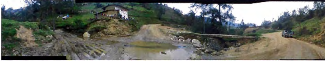
Badén en condiciones iniciales 2010
