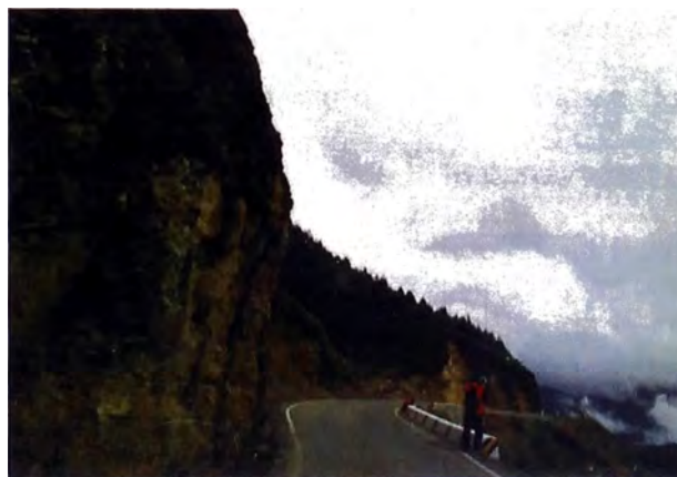
Zona crítica condición actual
