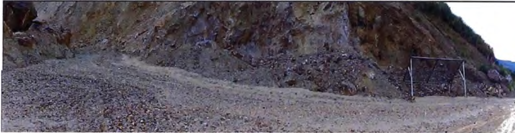
Deslizamiento (huaico), en zona de canteras
