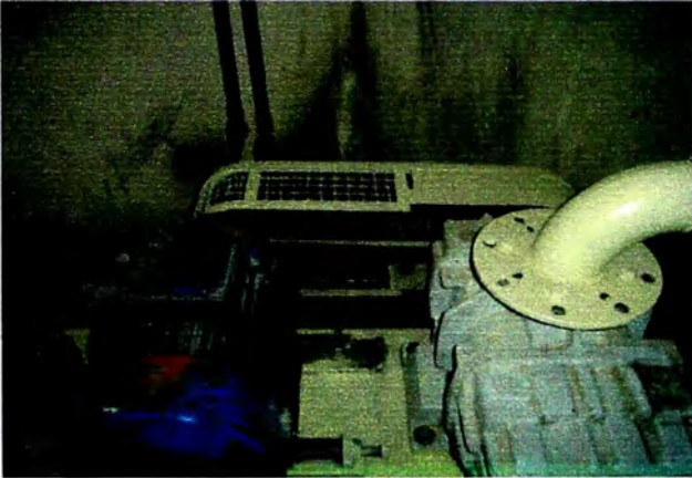
Guarda que permite ver el estado de la faja de transmisión sin necesidad de retirarla. Bomba de Fluidizado.
