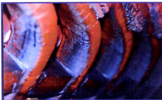
Fig. 4.4.- Deterioro por contaminación
