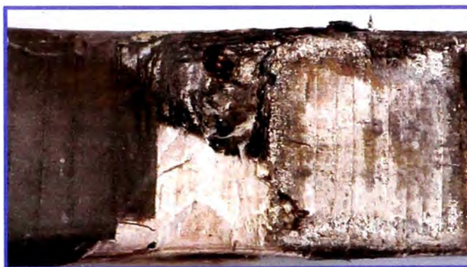
Fig. 4.2.- Daño por empaque incorrecto
