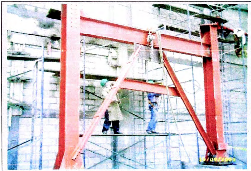
Figura 5.2: Instalación de arrioste entre columnas y viga de amarre de un pórtico
