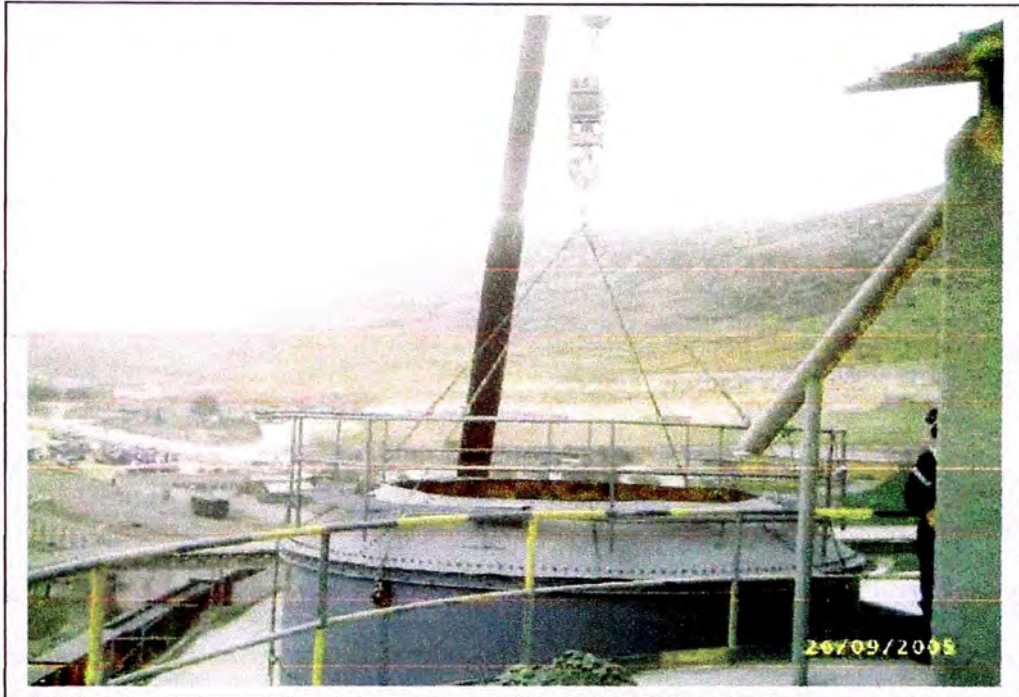
Figura 5.24: Vista parte superior del montaje
