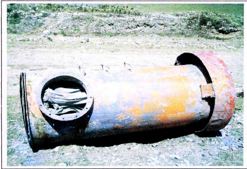
Figura 4.6: Filtro desmontado ubicado en el nivel cero
