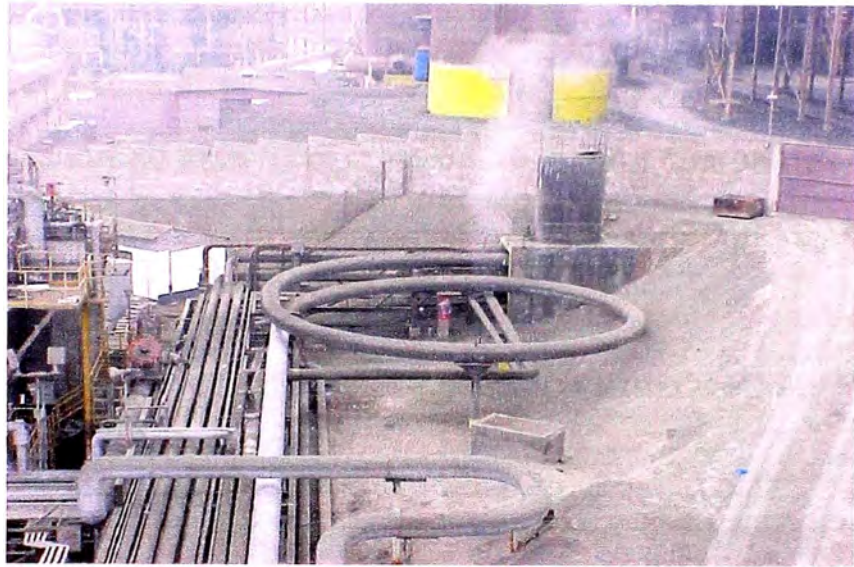
Figura N°2.6 – Descarga de los Calderos de Recuperación
