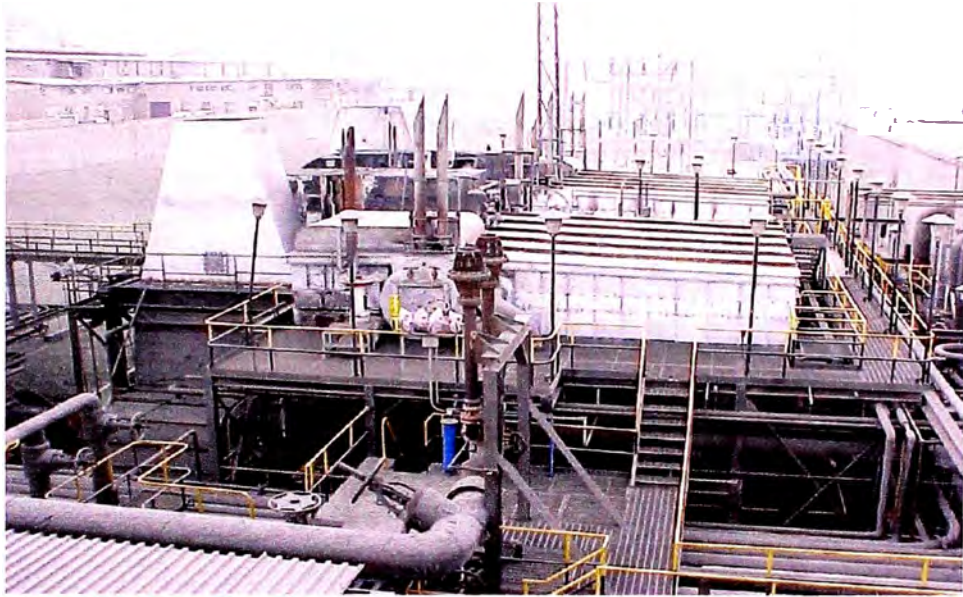
Figura N°2.3 – Calderos N°1 y N°2
