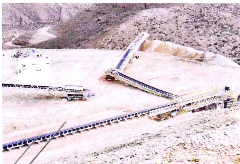
Figura No. 1-3: Área 1 300. Sistemas de Fajas Móviles hacia Zona de depósitos.
