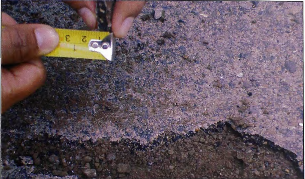
Anexo F-5.- Carpeta asfáltica actual deteriorada Fuente: Elaboración Propia
