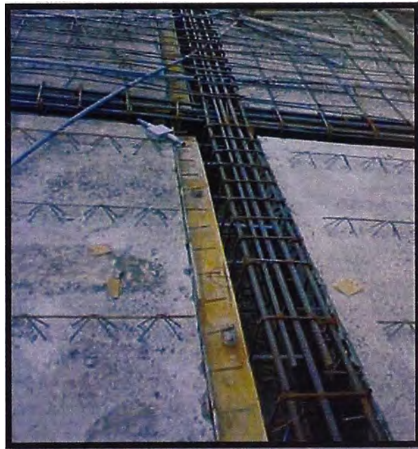
Figura 3.12: Prelosas con dimensiones incorrectas.
