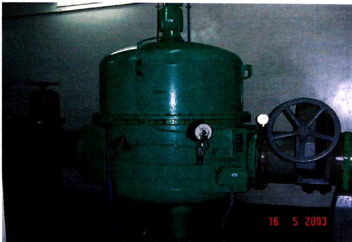
Figura 3.2 (Filtro de agua del sistema de refrigeración)
