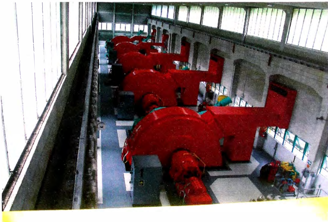
Figura 2.2 (Sala de Máquinas de la Central Hidroeléctrica – Yaupi)
