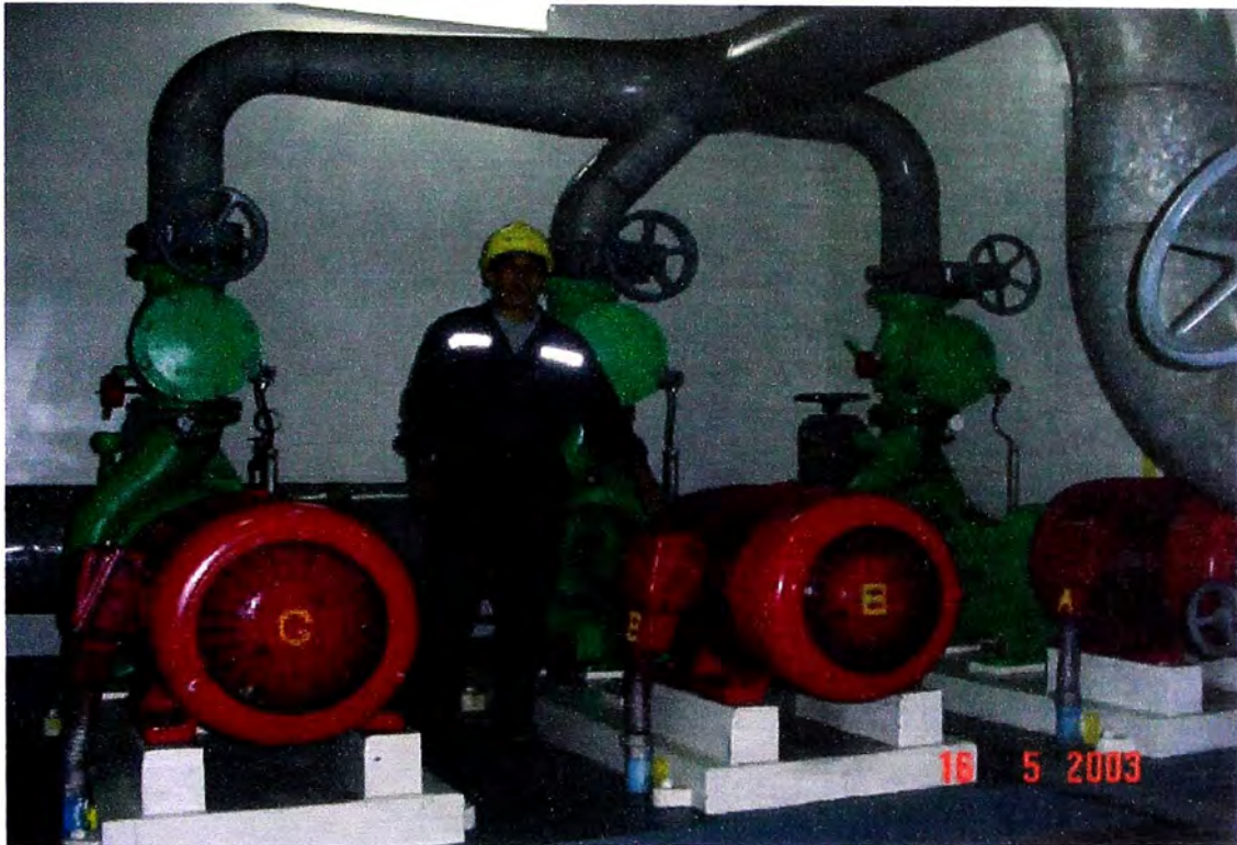
Figura 3.4 (Bombas principales del sistema de refrigeración C.H. – Yaupi)
