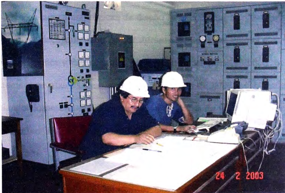
Figura 2.4 (Centro de Control de la Central Hidroeléctrica – Yaupi)
