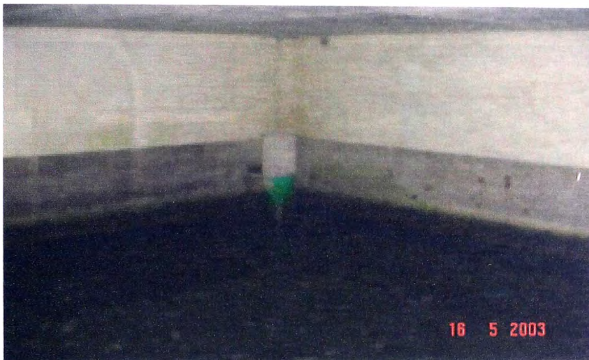
Figura 5.5 (Reservorio de Agua de Refrigeración de la C.H. – Yaupi)
