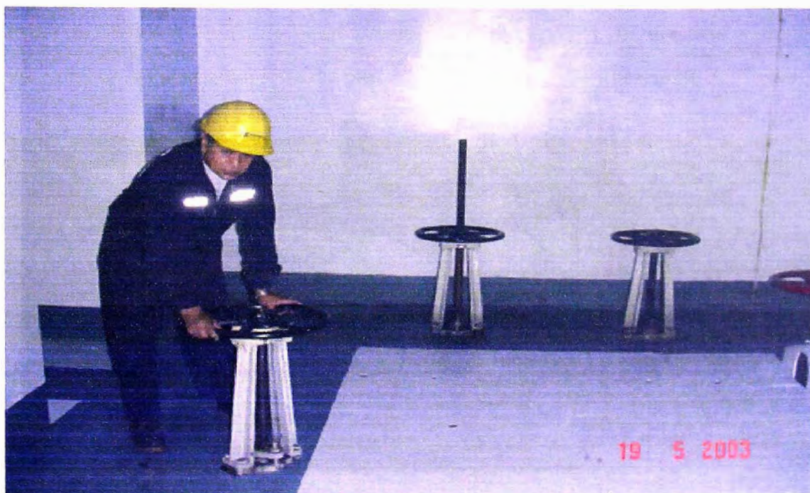
Figura 5.8 (Válvulas Tipo compuerta del Sistema Auxiliar de Refrigeración)
