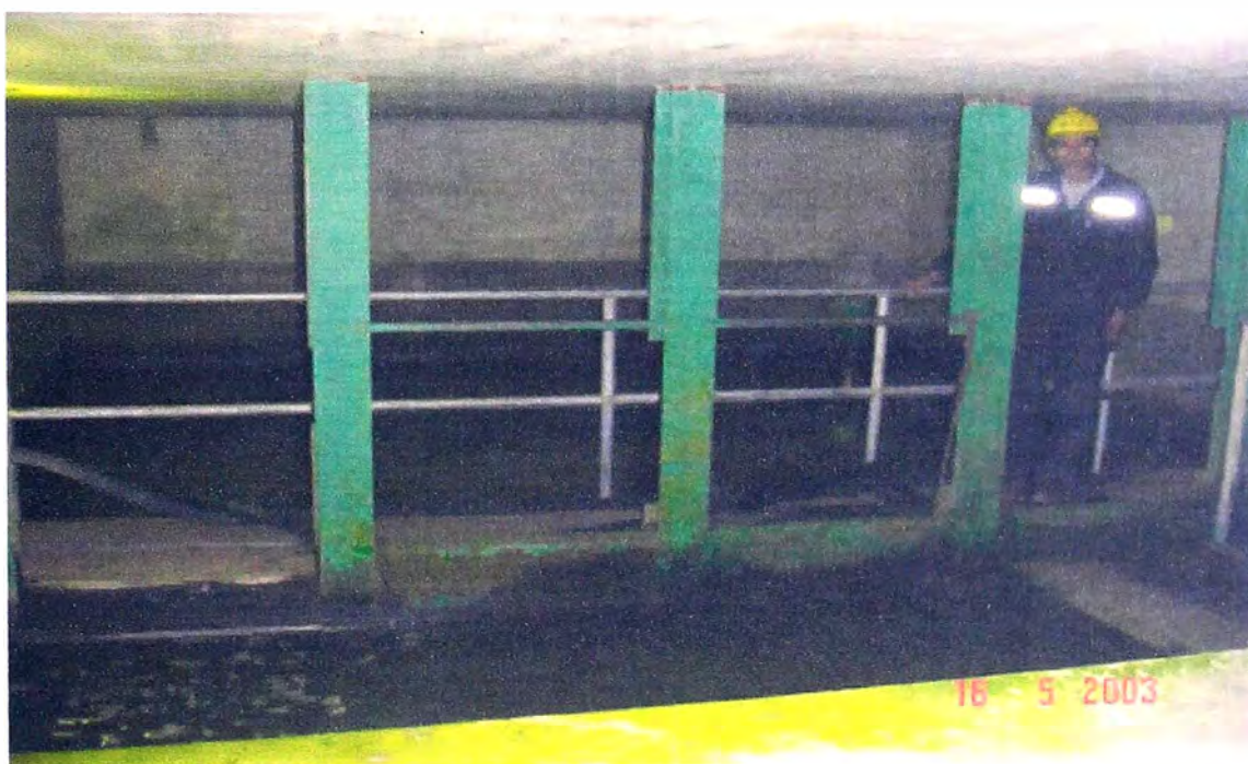
Figura 5.4 (Reservorio de Agua de Refrigeración de la C.H. – Yaupi)
