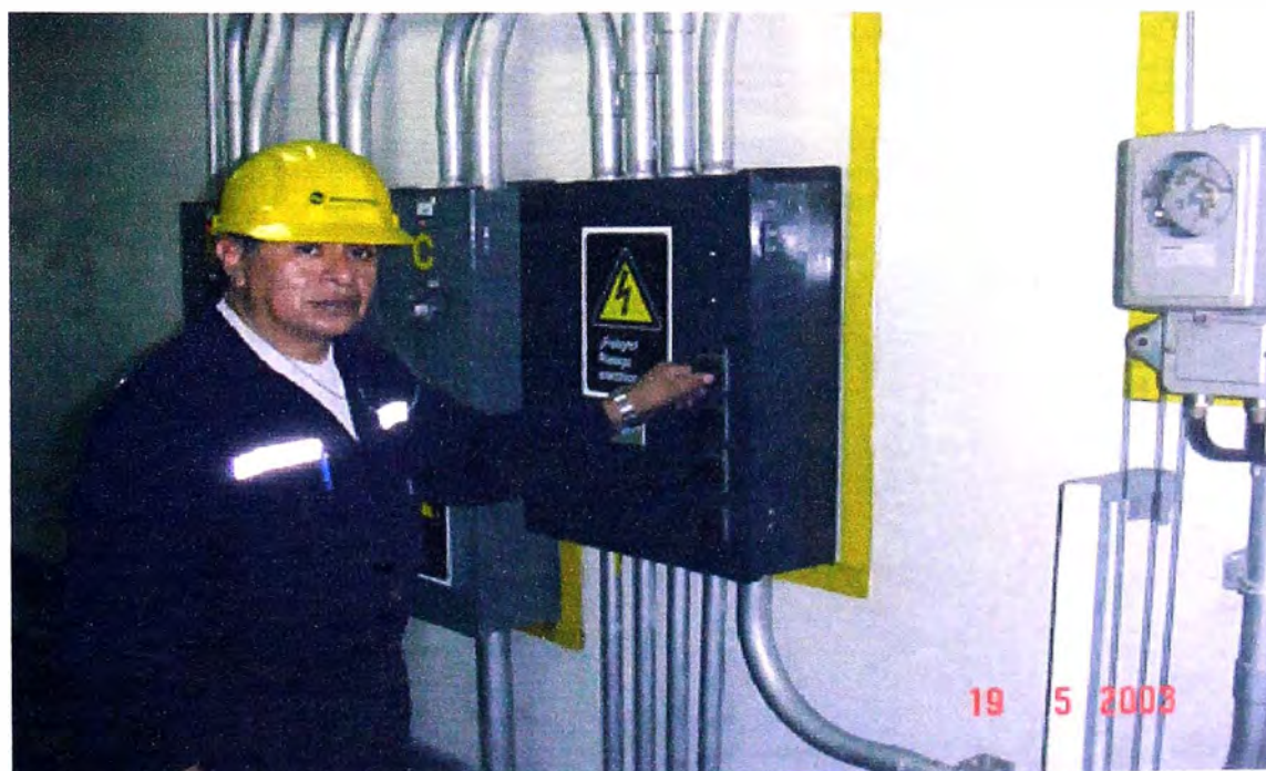
Figura 5.6 (Tablero de Bombas Principales de Agua la C.H. – Yaupi)
