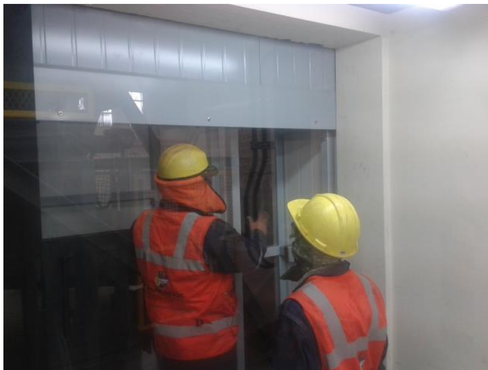
Figura 1.10: Sub contratista de Cidelsa (Empresa Ejecutora) en labores de colocación de termomuro.
