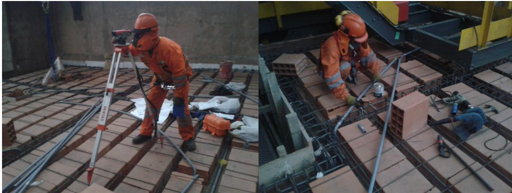
Figura 4.3: Trabajadores de Cidelsa en sus labores con sus respectivos implementos de seguridad.
