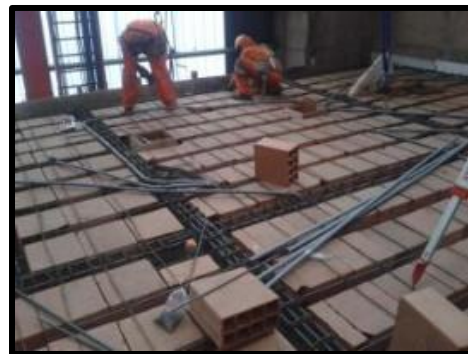
Instalaciones eléctricas en losa aligerada
