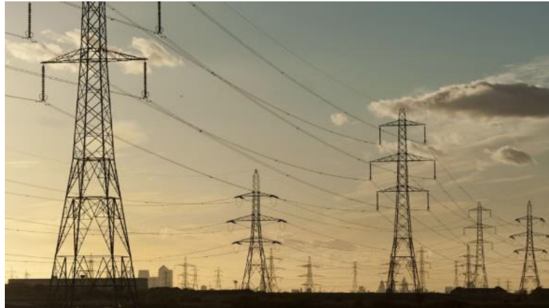
Figura N° 1 Línea de transmisión de energía eléctrica
