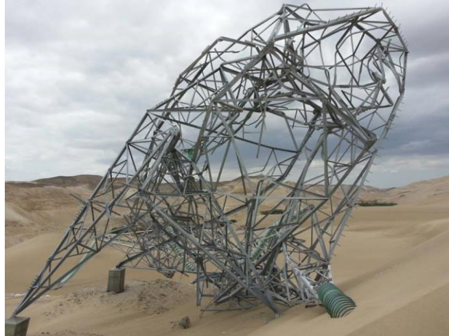
Figura N° 2 Colapso de estructura de transmisión
