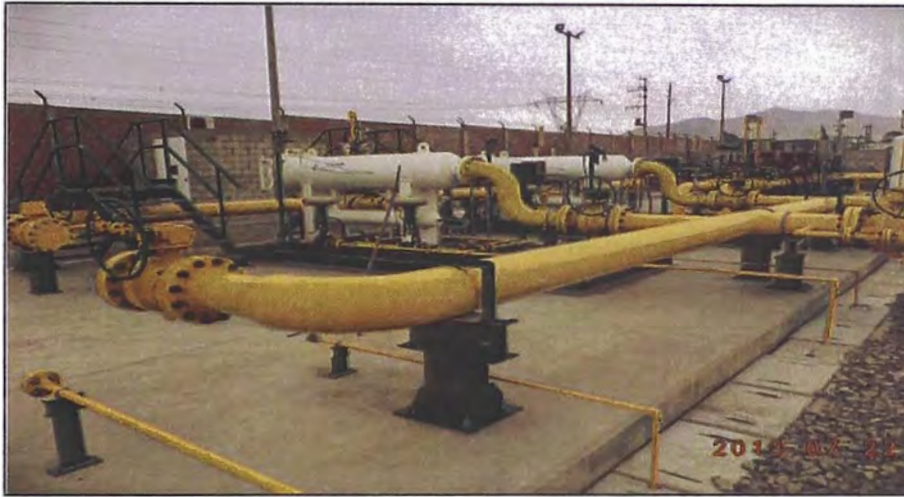
Figura 3.6: Acondicionamiento del Gas Natural para el ingreso a la Central.
