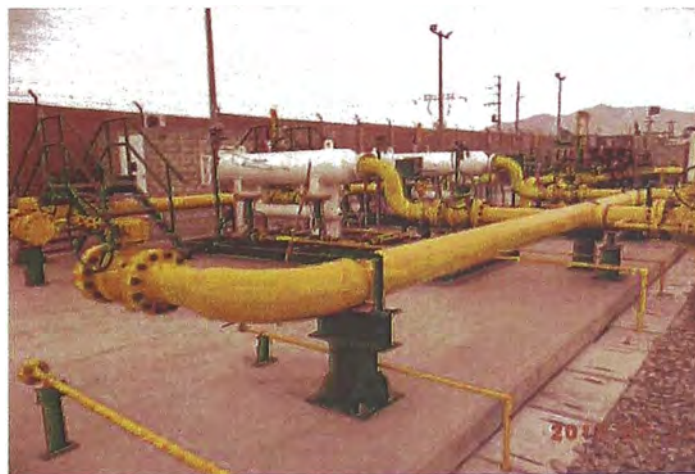
Figura 18: Acondicionamiento del Gas natural para el ingreso a la central
