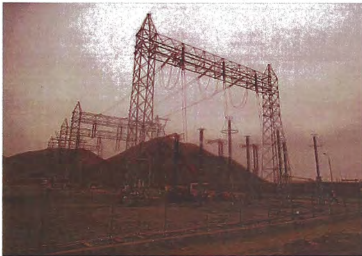
Figura 17: Torre de alta tensión, transportadora de energía
