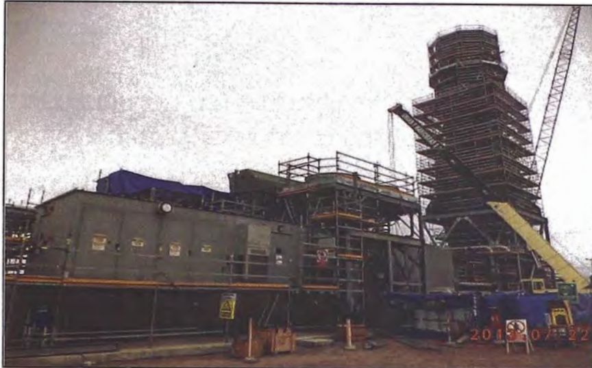
Figura 3.8: Turbina a Gas de la S.E Santo Domingo de los Olleros.
