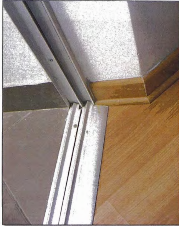
Foto 4.7: Espacio entre pared y zócalo defectuoso.
