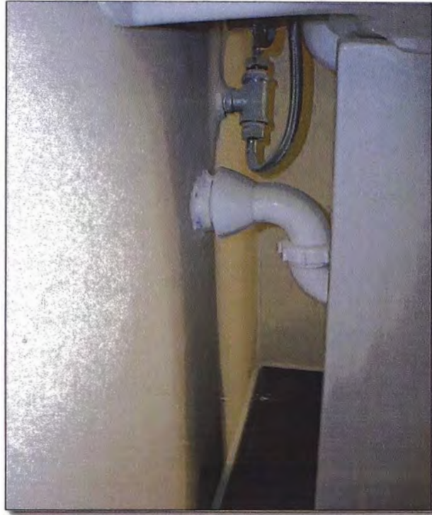
Foto 6.1: mala terminación del desagüe.
