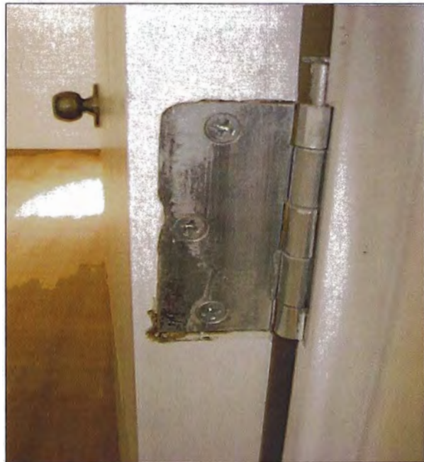
Foto 1.4: Mala colocación de bisagra
