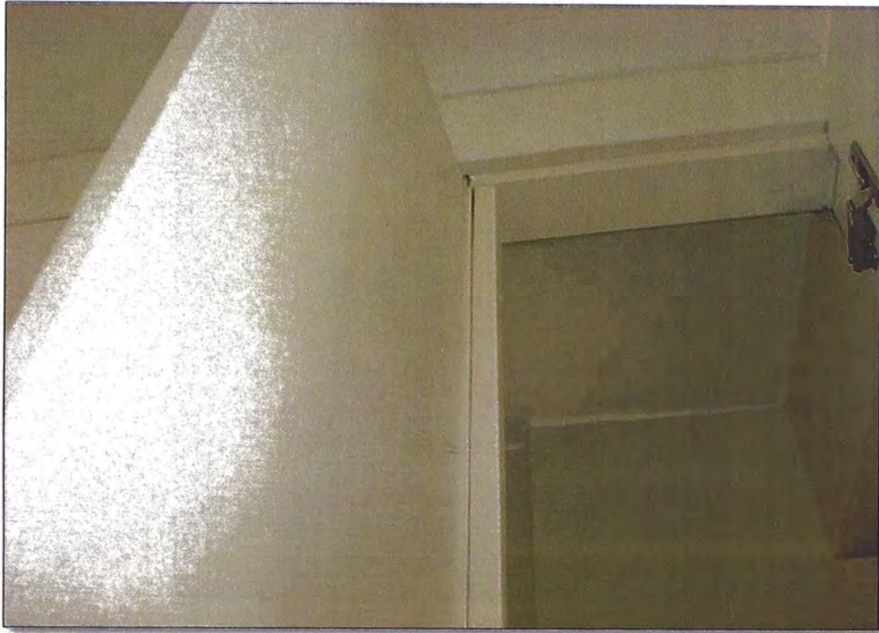
Foto 5.5: Mala terminación de marco.
