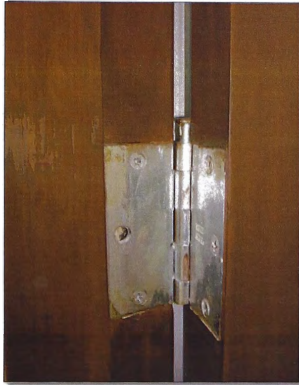
Foto 1.3: Colocación incompleta de bisagra.
