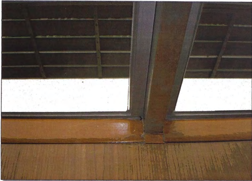
Foto 4.9: Mala terminación de encuentro con mampara.
