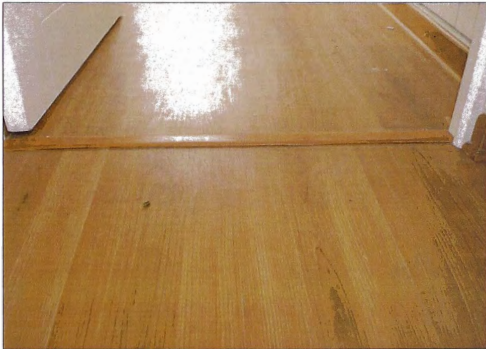
Foto 4.8: Mala colocación de tapa junta (está levantada).
