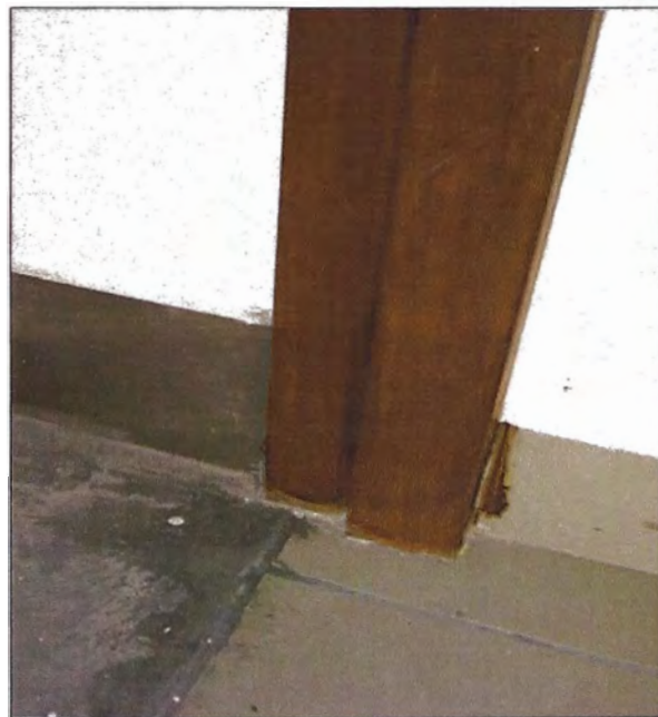
Foto 1.2: Mal acabado de pintura de marco de madera.
