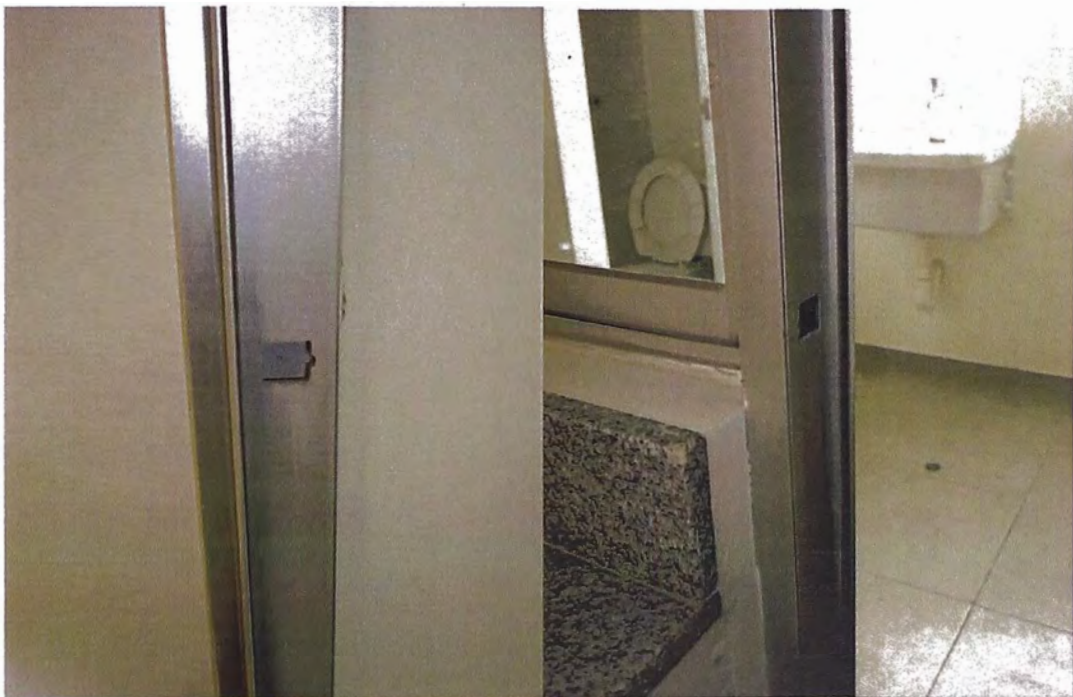
Foto 2.6: falta el acabado para el accesorio hembra de la puerta.
