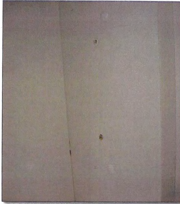
Foto 5.3: Falta tapones a los tornillos.
