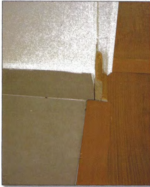
Foto 4.3: Mala terminación de zócalo.
