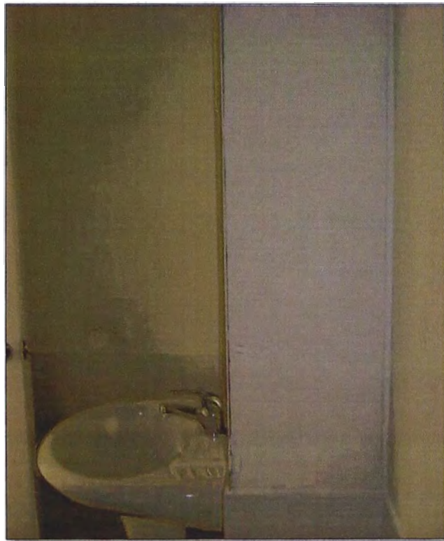
Foto 3.3: mejor acabado en el encuentro de espejo y arista de la columna.
