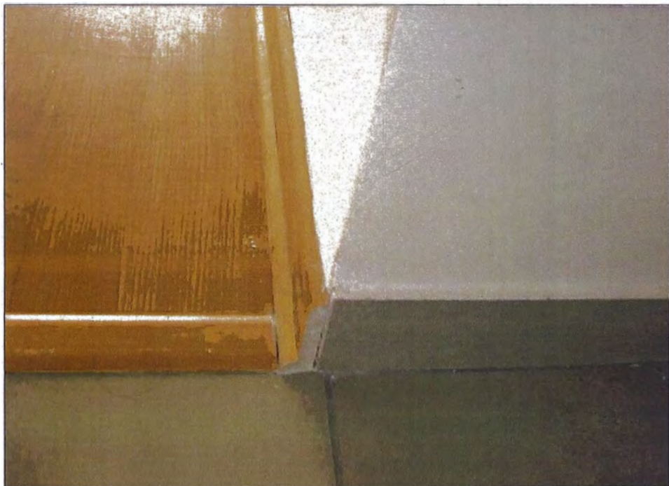
Foto 4.4: Mal encuentro de zocalo de madera y ceramico.
