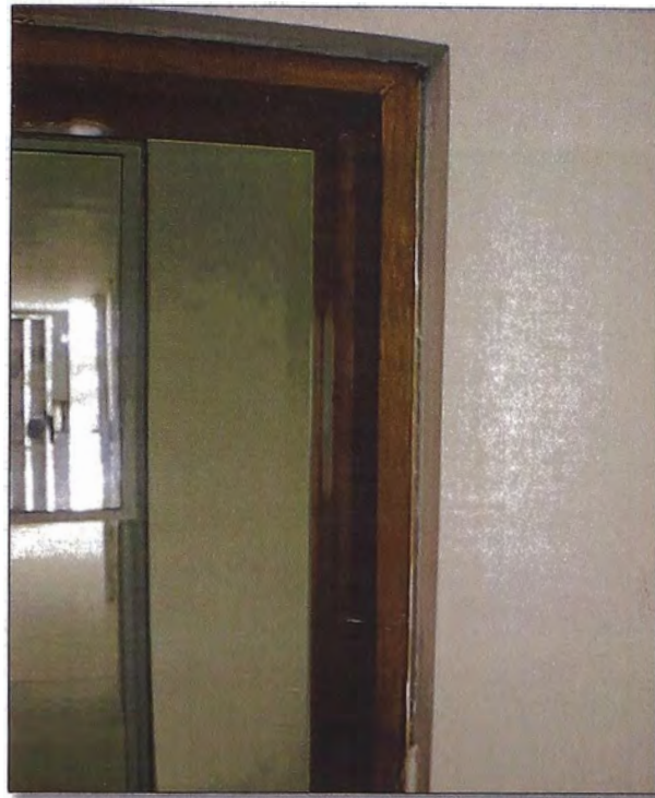
Foto 1.5: Mal acabado del derrame trayendo consigo desperfectos.
