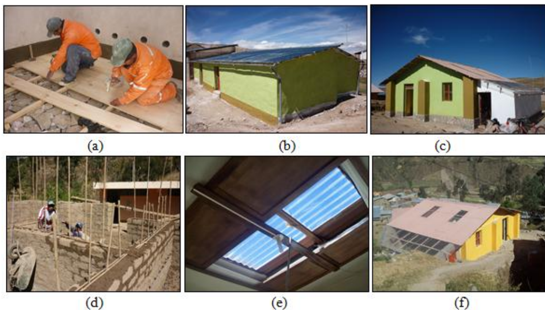
Figura 5. Comunidad de San Felipe, (a) aislamiento de pisos, (b) vivienda rehabilitada, (c) vivienda nueva. Comunidad de Santa Rosa de Tambo, (d) muros reforzados con caña brava, (e) claraboyas, (f) vivienda nueva.
