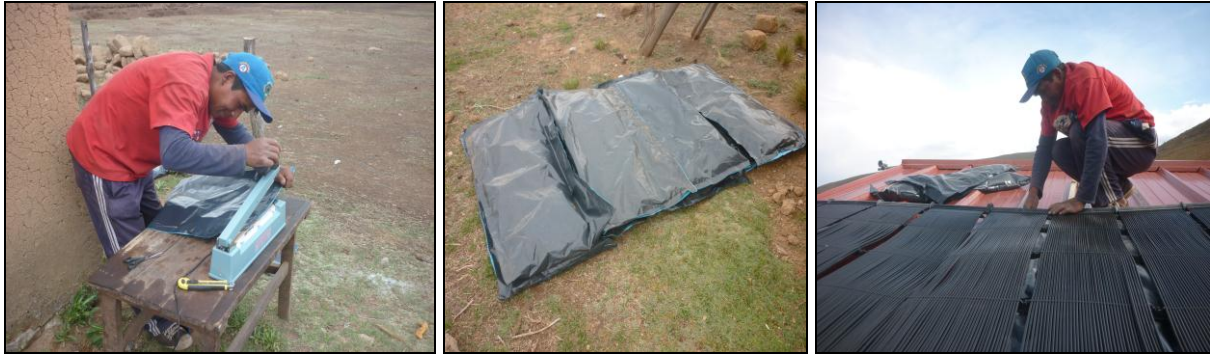
Figura 74. (Izq.) sellado de bolsas contenedoras de lana de roca; (Cen.) colchonetas de lana de roca confeccionadas; (Der.) colocación de colchonetas debajo del colector solar tipo piscina.
