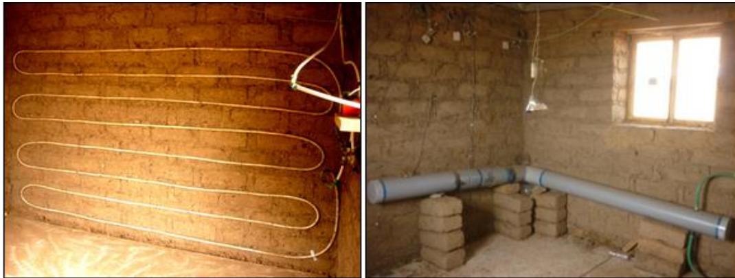
Figura 1. (Izq.) Vista del serpentín del muro radiante. (Der.) Vista del tubo radiante.
