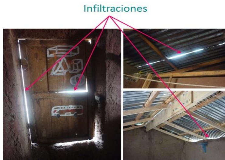
Figura 54. Vistas de las infiltraciones de aire en puertas, vanos y techos de una vivienda.
