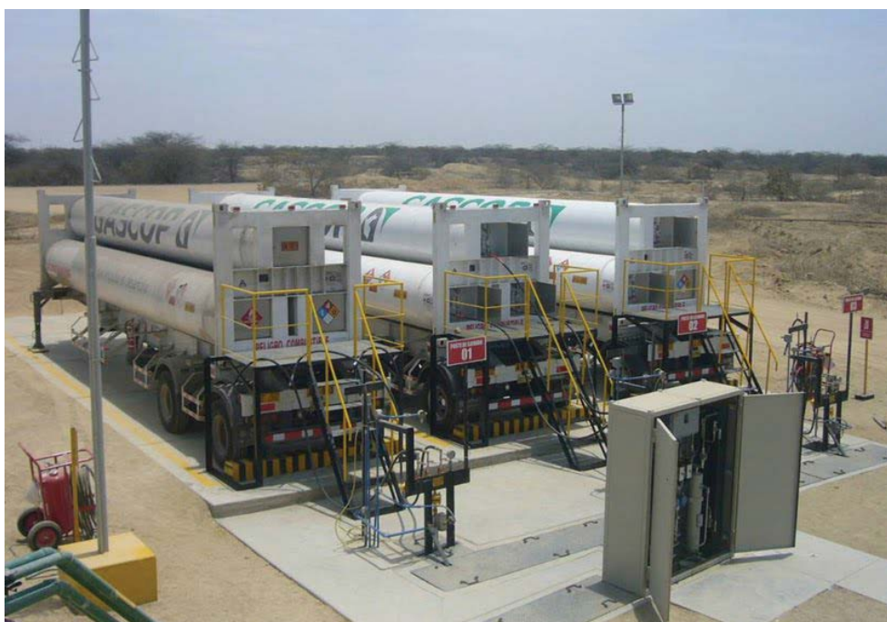
Figura N° 2.10 Estación de Compresión de la Empresa GASCOP – El Alto Talara
