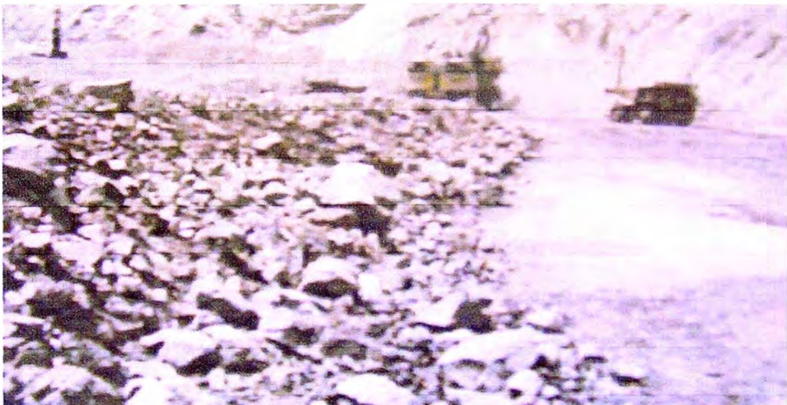
Fotografía 4.6 Bermas de protección con rocas y piedras
