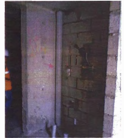
Tubería de agua que pasa por closet de lavadora
