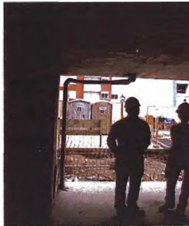
Montante sanitaria en pase vehicular
