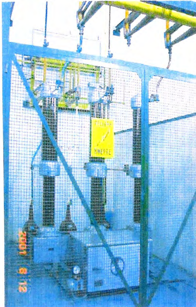
Equipos de celda
