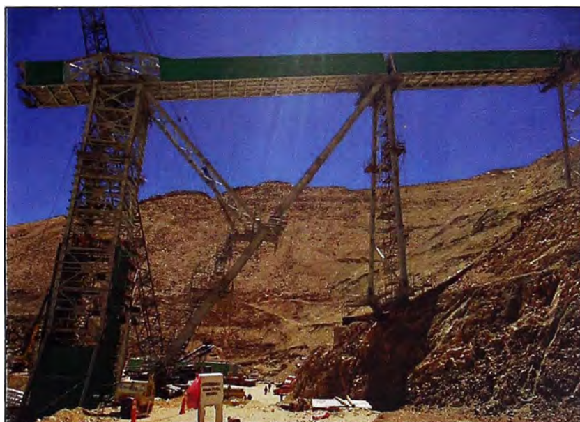
Figura N°A-14.- Extremo final de estructura para la correa transportadora (Sector Stacker)
