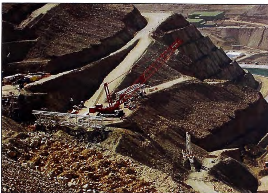
Figura N°A-11.- Montaje de una estructura de apoyo (cepa) para las galerías
