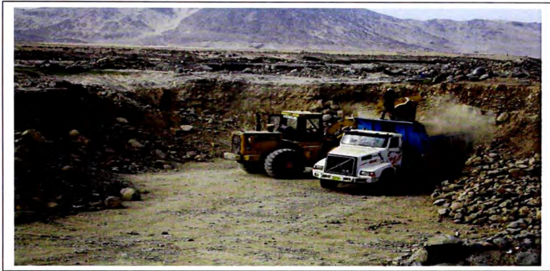
Cantera El Milagro: Extracción del Hormigón del banco de material y cargado al camión, para ser trasladado al punto de zarandeo
