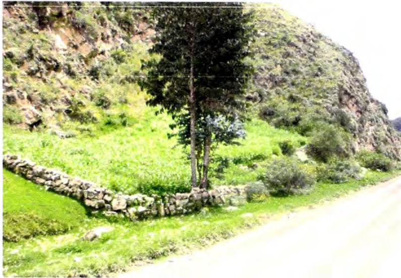
Figura N°2.5.- Cerco perimétrico de pirca, ubicado en Km. 1+950, afectado por los trabajos en la carretera
