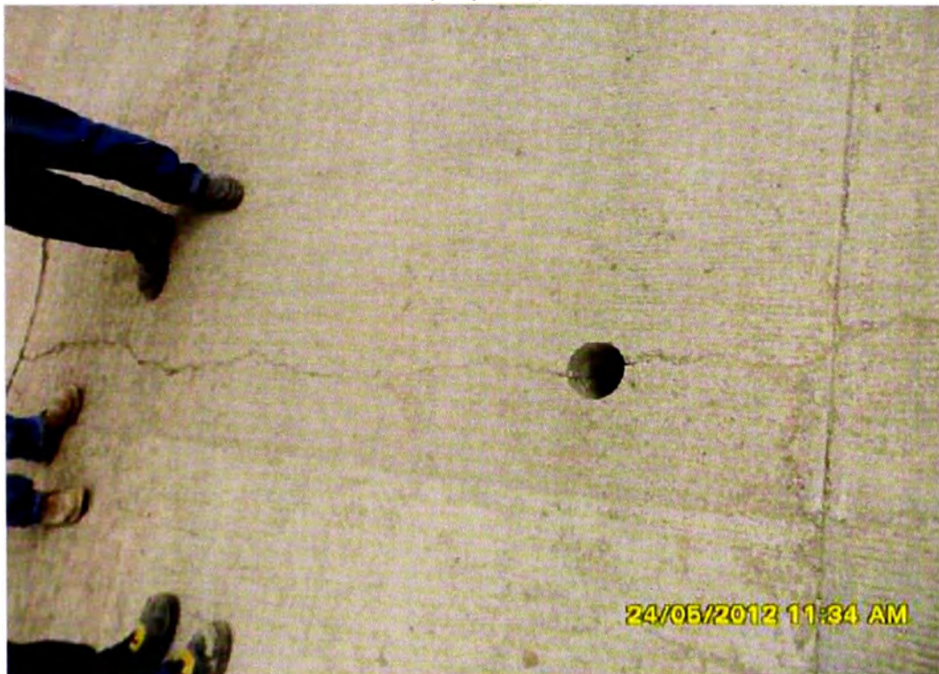
FISURA EN PISO
