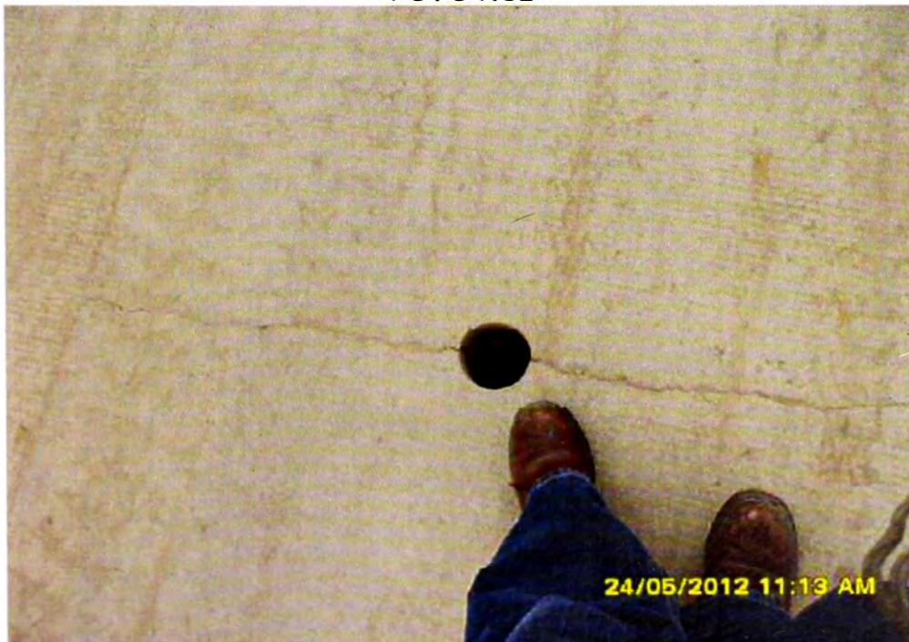
FISURA EN PISO
