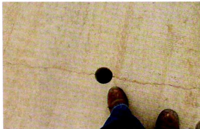
Figura 4.1 - Fisura en pavimento de concreto asfáltico
