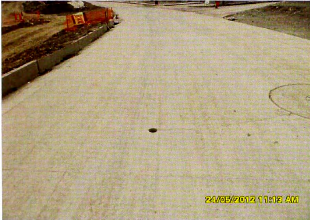
FISURA EN PISO
