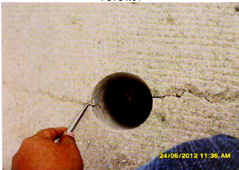
FISURA EN PISO
