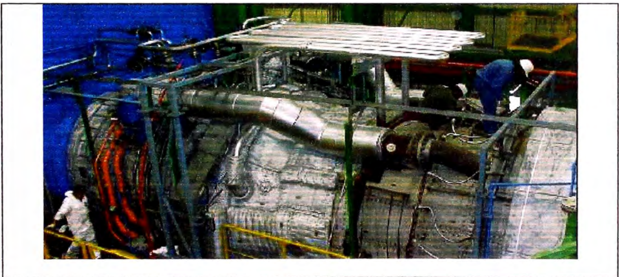
Figura 56: Sistema de aire de Sellado - Serpentín
