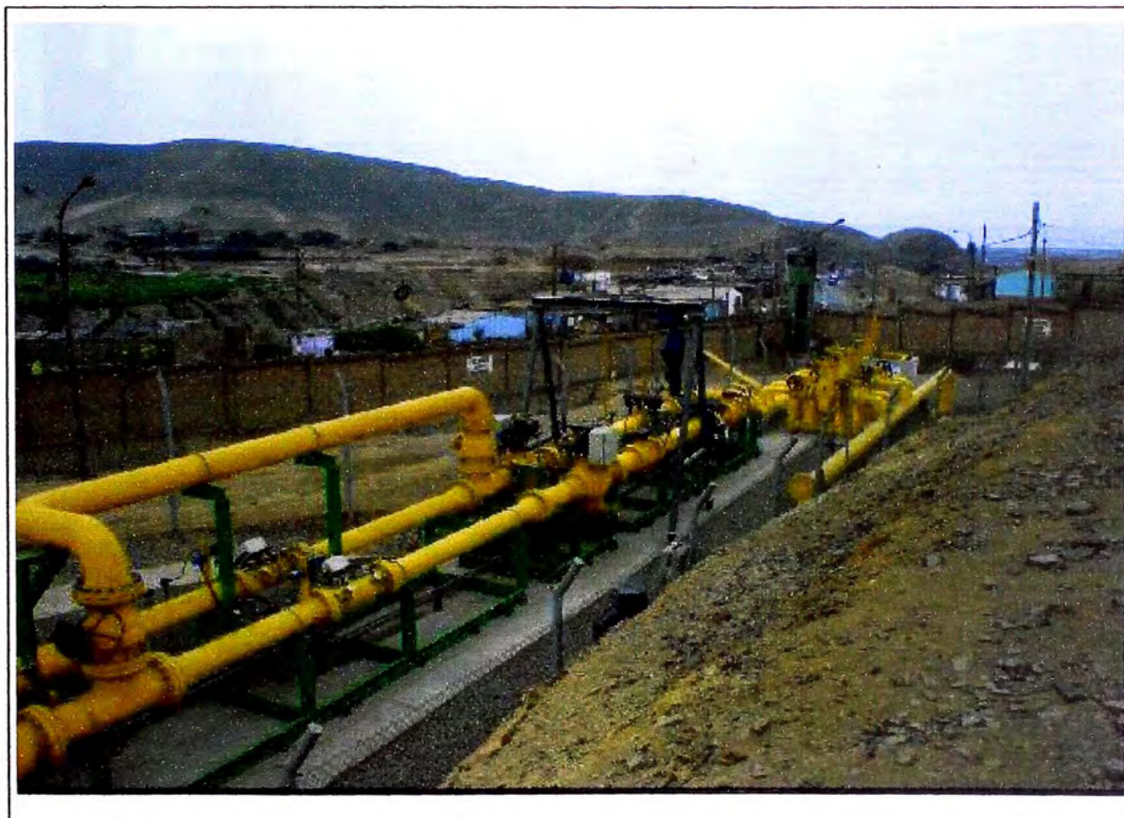
Figura 15: Estación de Regulación de Calidda en Etevensa
