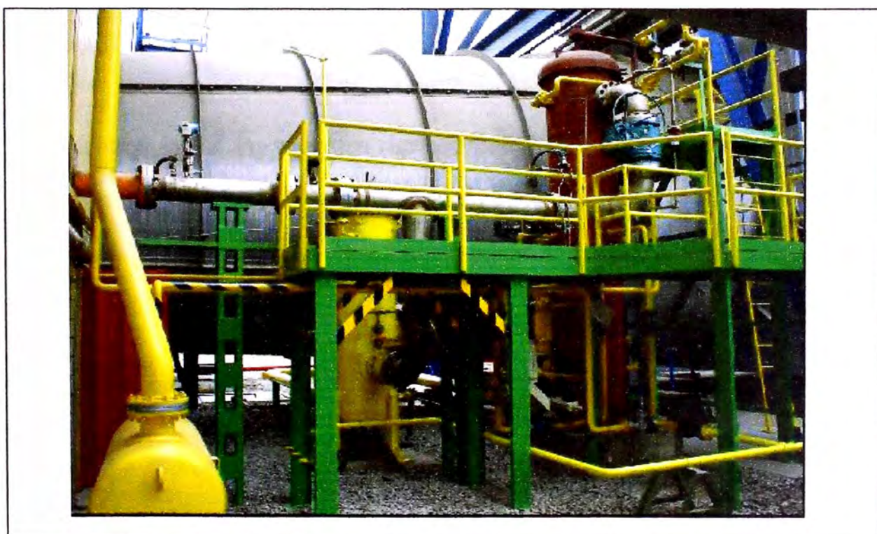
Figura 21: Sistema de Filtración del suministro de Gas Natural TG 03
