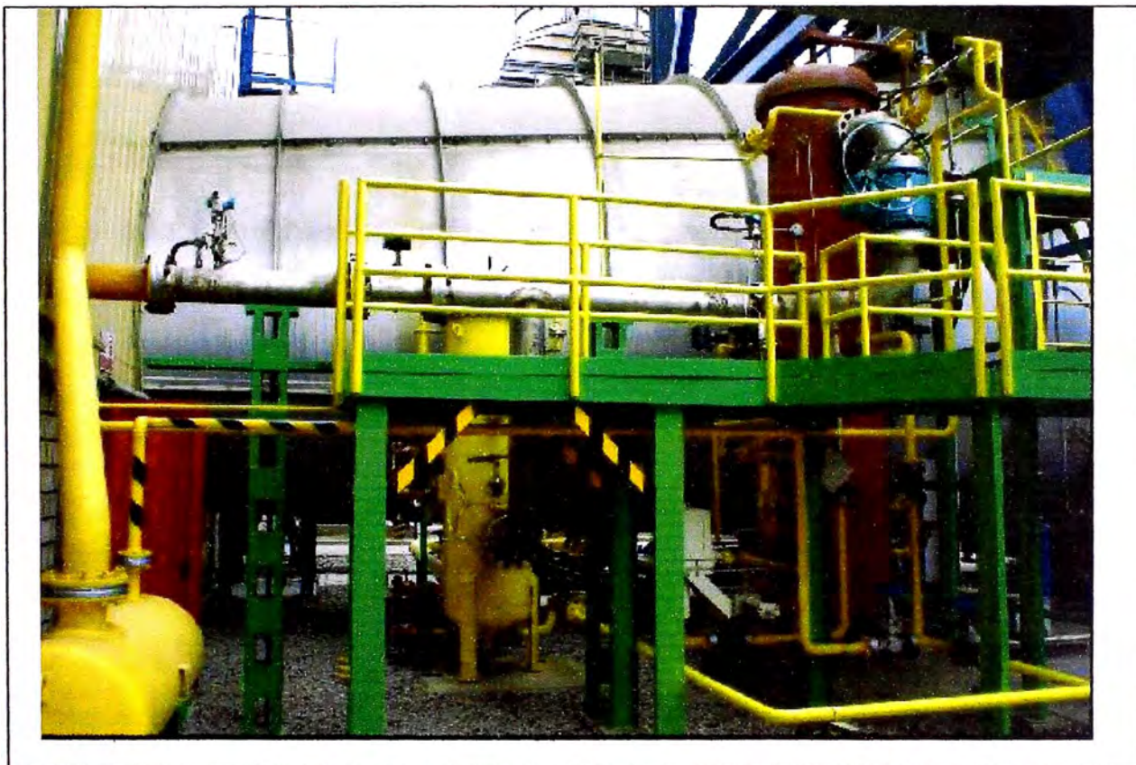
Figura 22: Sistema de Filtración del suministro de Gas Natural TG 04
