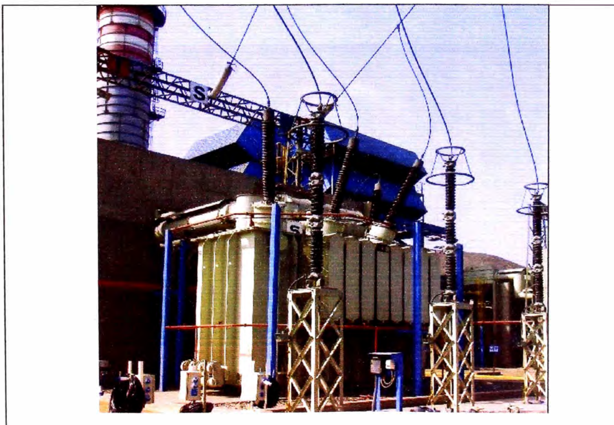
Figura 43: Transformador de 220 KV
