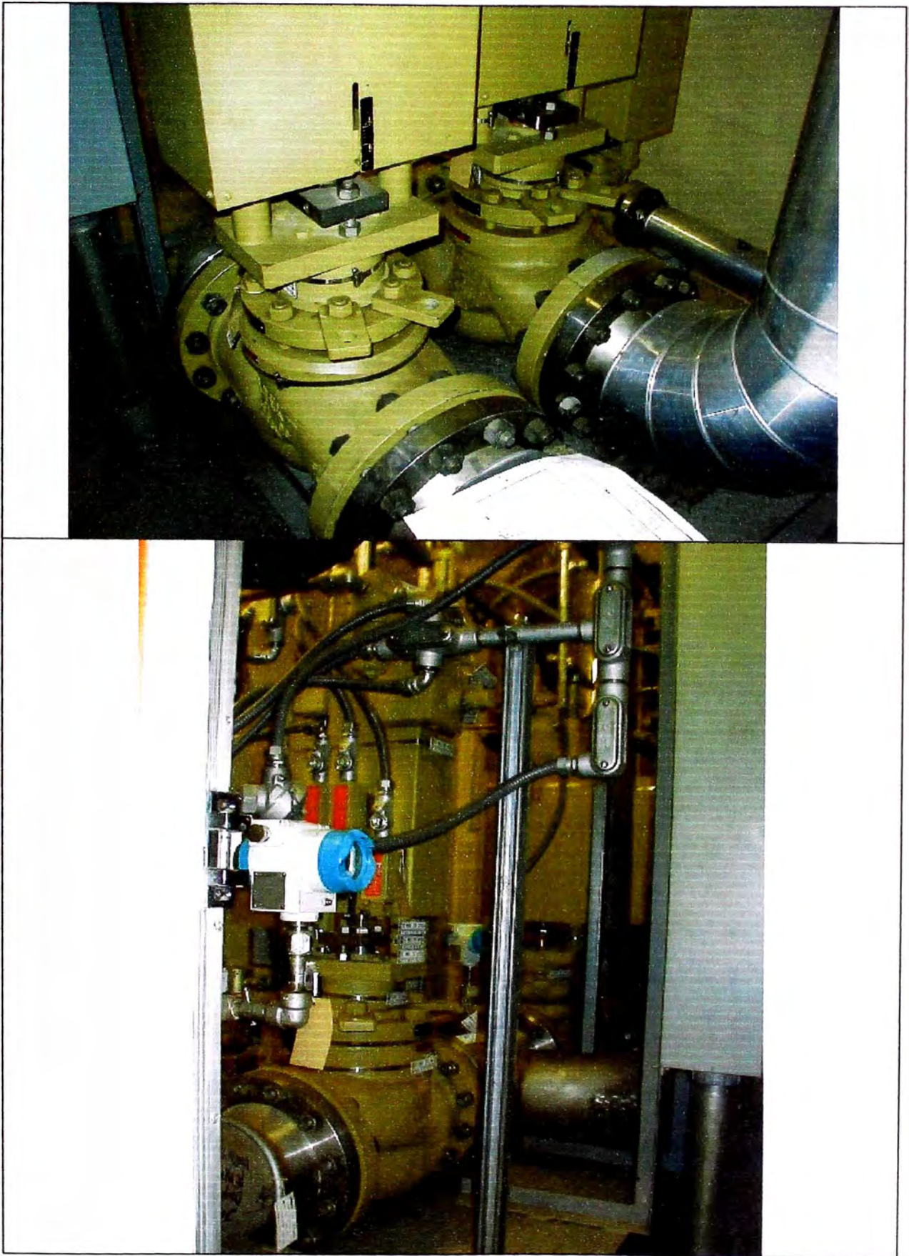
Figura 54: Antiguo Skid de Regulación de Gas Natural
