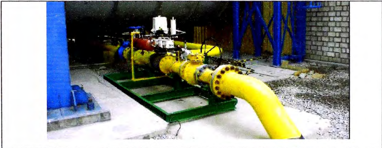
Figura 19: Sistema de Corte del suministro de Gas Natural TG 03
