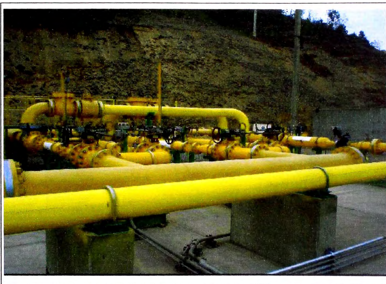
Figura 18: Sistema de Regulación del suministro de Gas Natural TG 03 / TG 04
