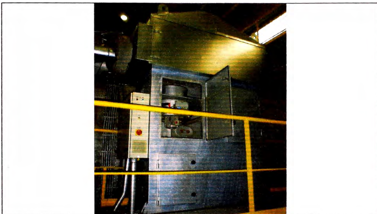
Figura 57: Nuevo Sistema de aire de Sellado – Modulo de enfriamiento
