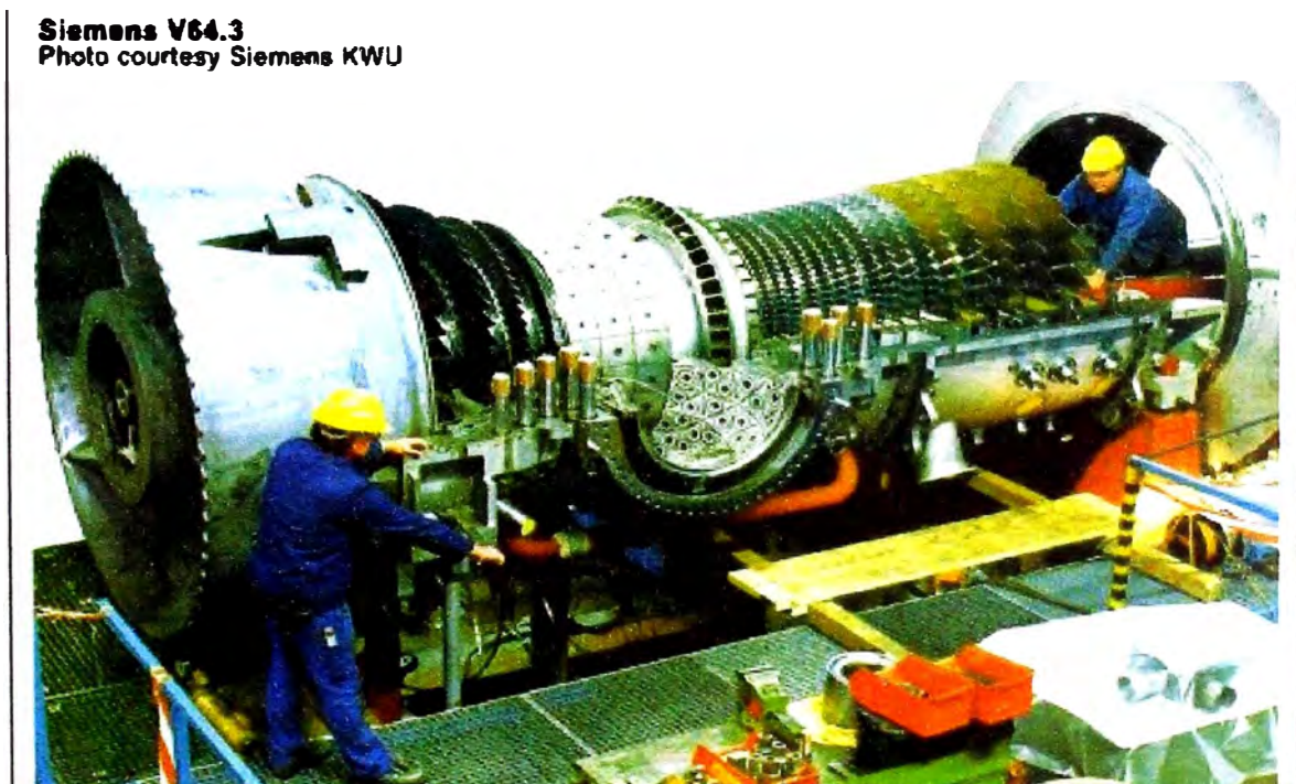
Figura 35: Turbina a Gas Siemens V64.3 (Desmontada)
