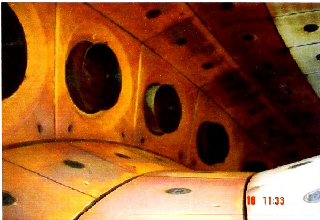
DISPOSICIÓN DE LOS QUEMADORES DESPUES DE LAS MODIFICACIONES GAS RETROFIT
