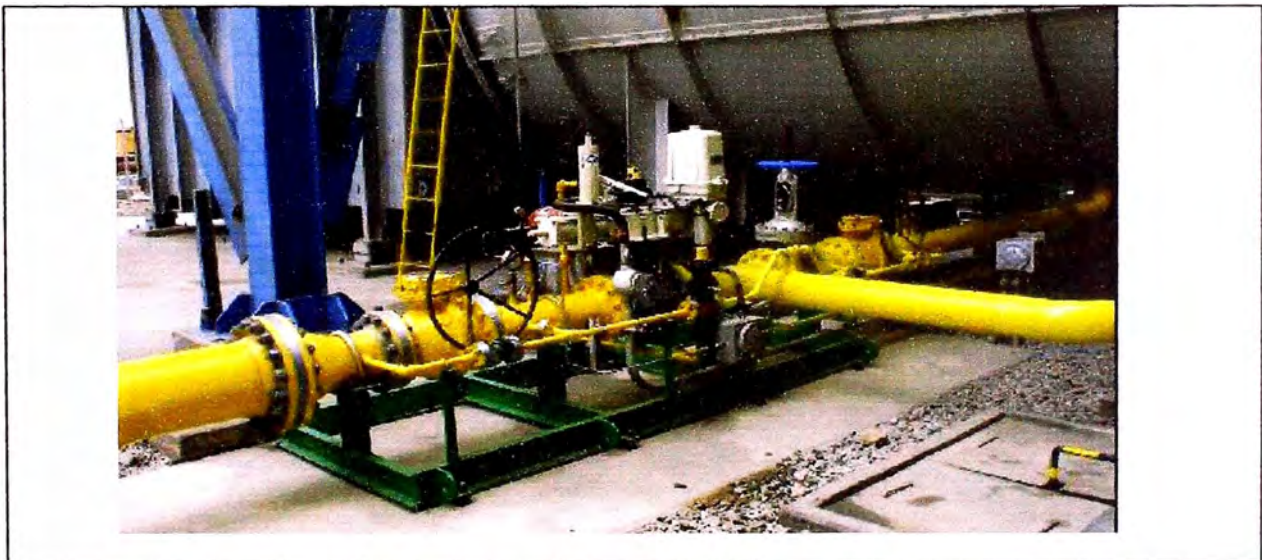
Figura 20: Sistema de Corte del suministro de Gas Natural TG 04
