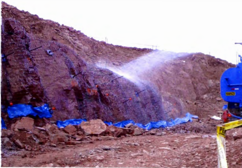
Figura N°4.20.- Humedecimiento del talud rocoso (Zona B1b)
