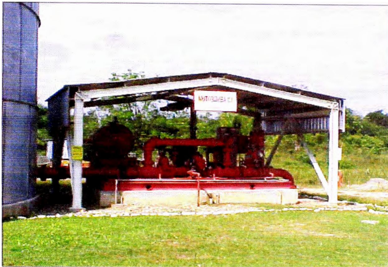
Fotografía #11 Una vista general de las instalaciones contra incendio.
