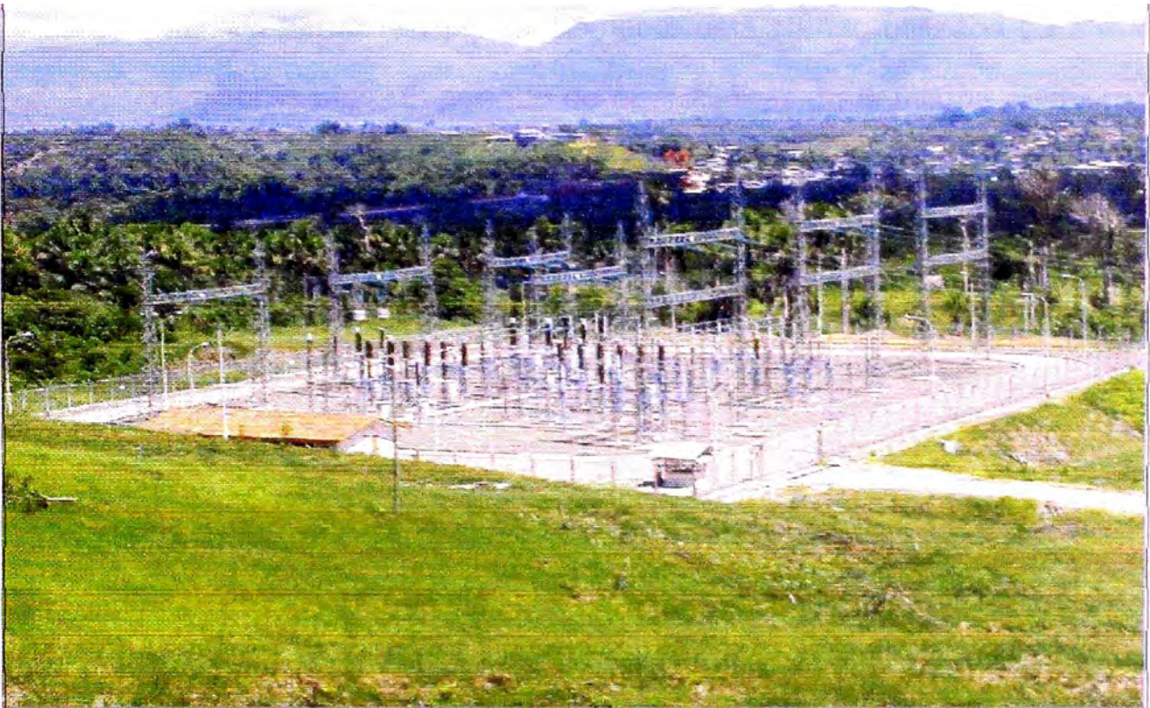
Figura # 7 Vista panorámica de la subestación Aguaytia.
