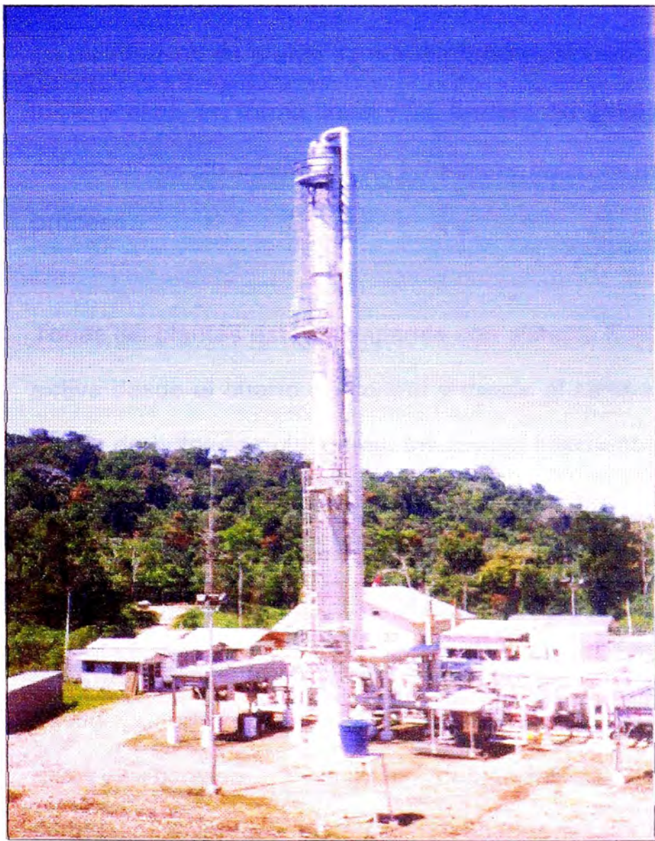
Figura # 1 Vista de la planta de separación de Gas en Zorillos.
