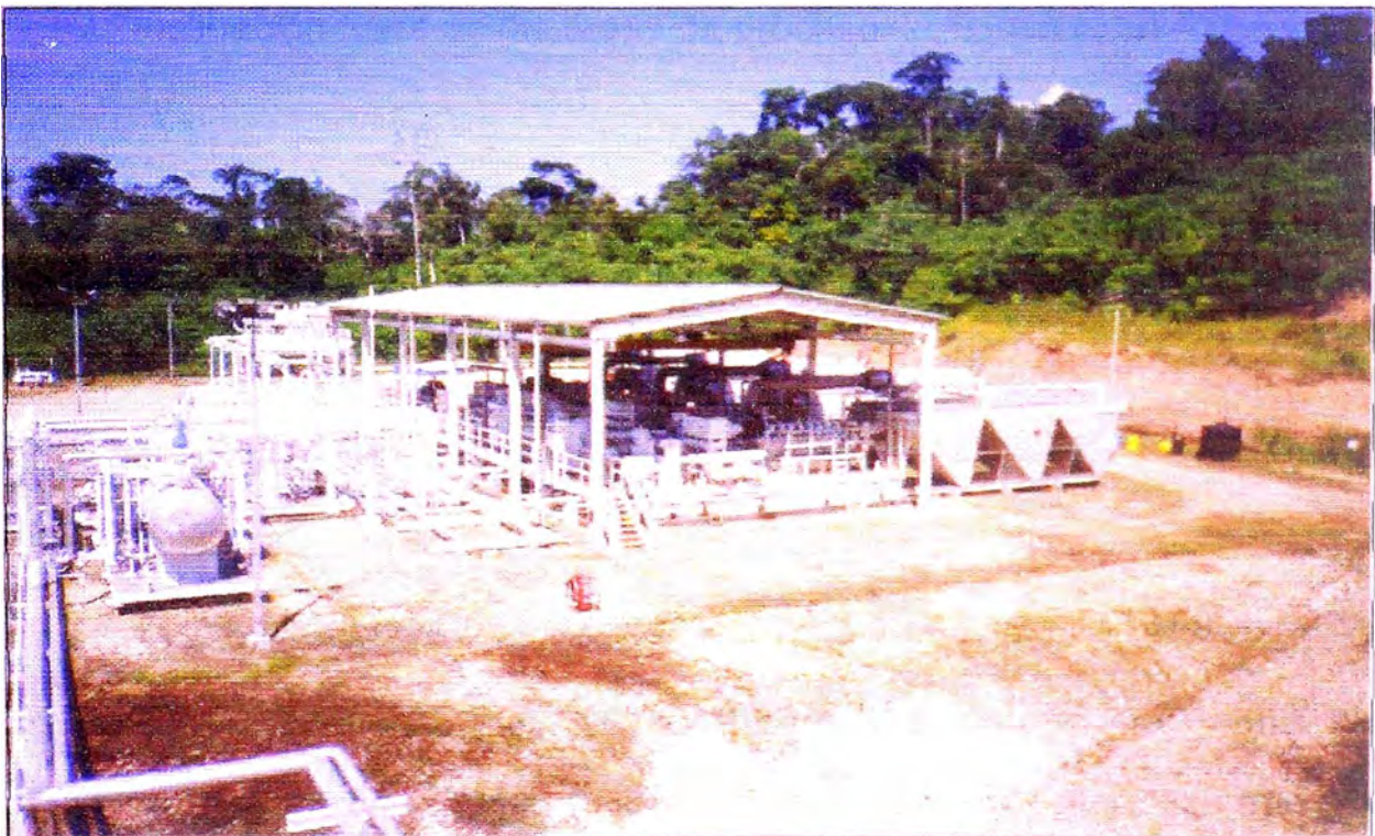
Figura #9 Vista de Casa de Compresión
