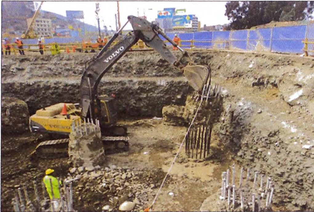
Figura N°3.19: Izaje del cabezal fracturado.
