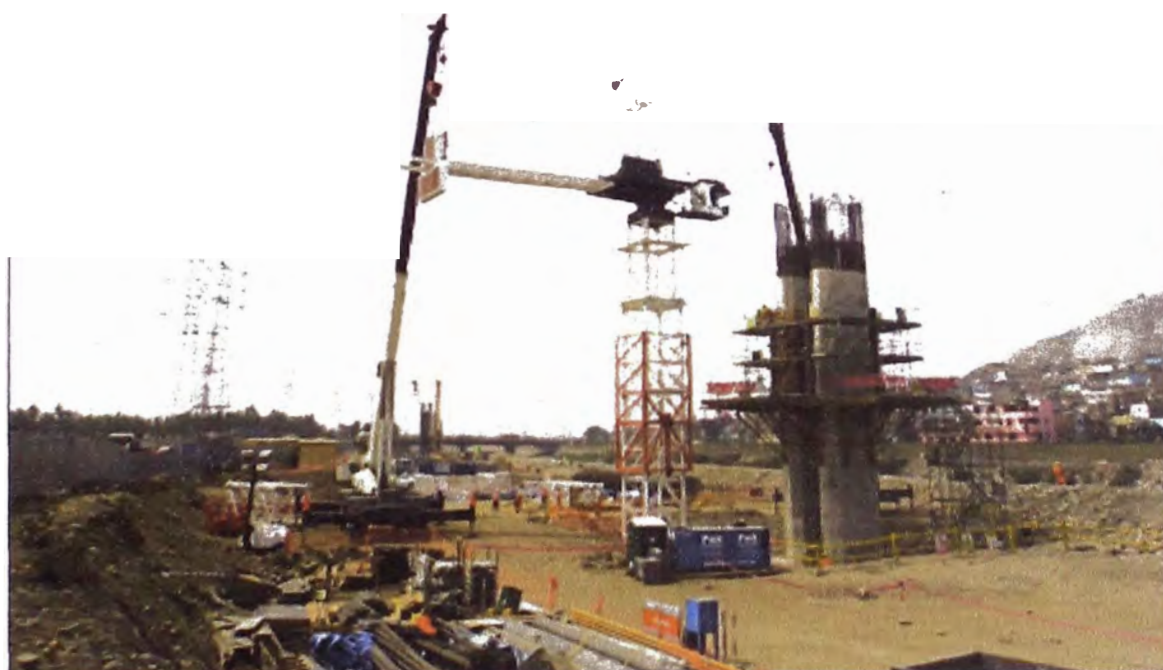
Figura N°3.44: Instalación de dos contrapesos ubicados en el extremo de la contraflecha – Eje O16.
