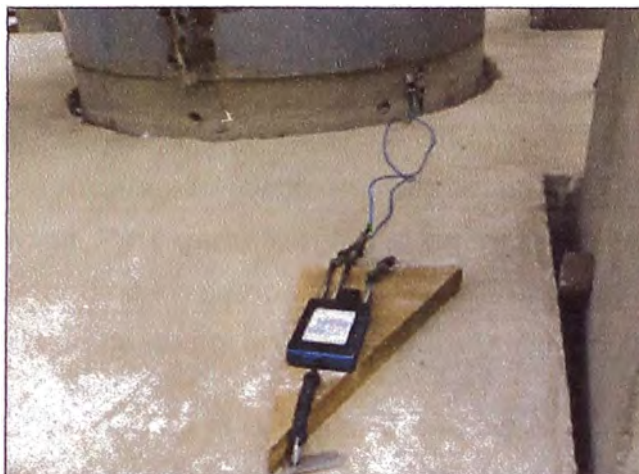
Figura N°3.22: Sensores de tensión y aceleración
