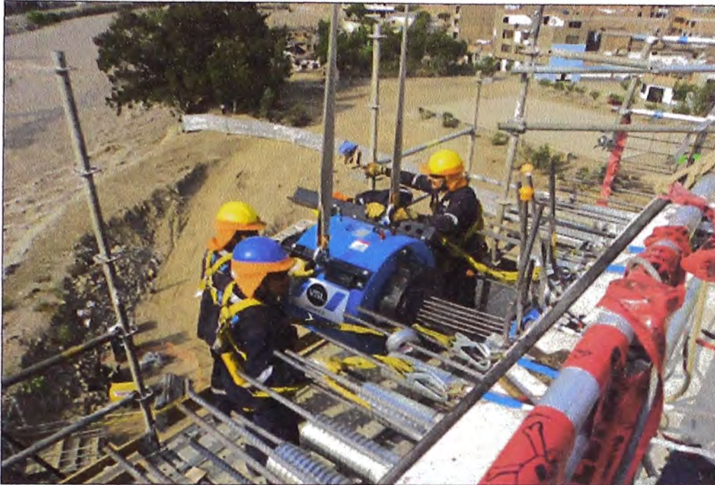
Figura N°3.62: Colocación del gato hidráulico para el postensado de cables- Dovela de arranque eje O16
