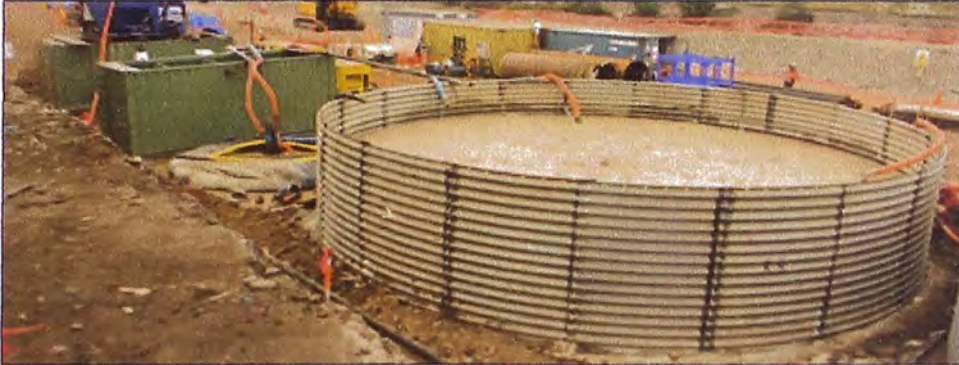
Figura N°3.6: Planta de lodo bentonítico.
