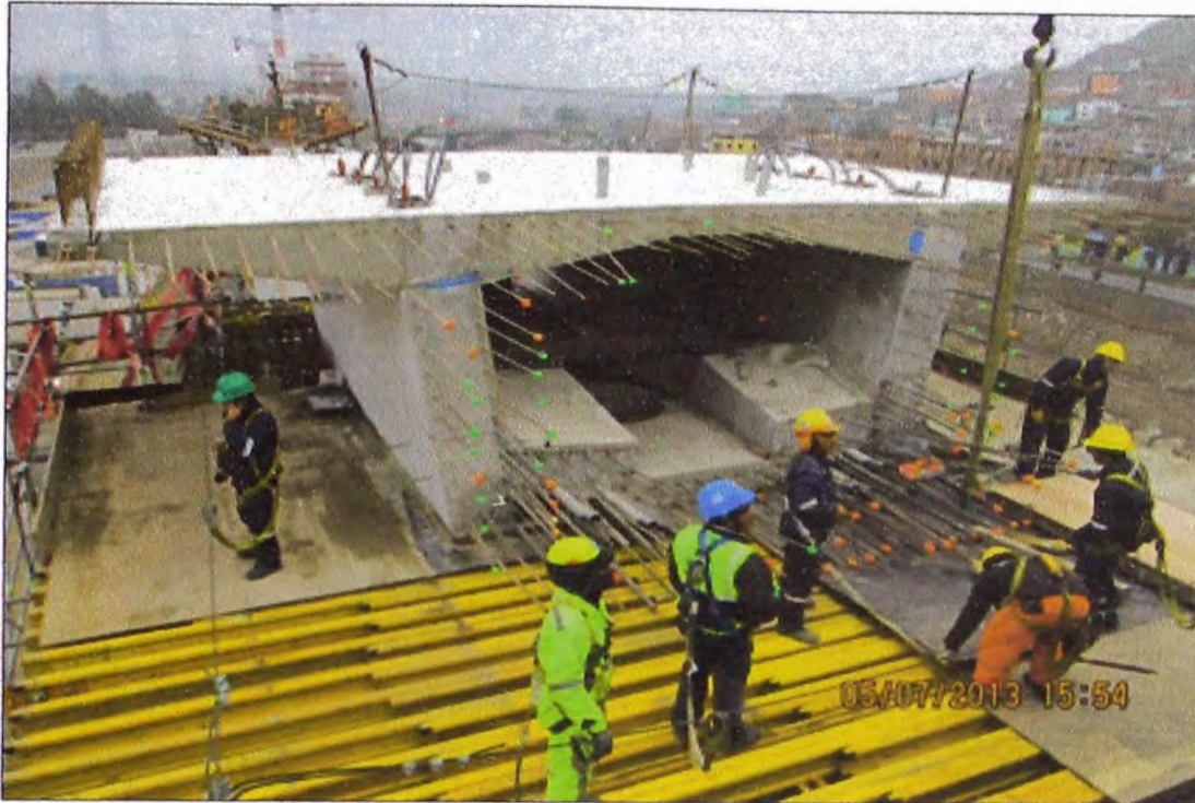
Figura N°3.82: Dovela extrema lateral – Eje O15
