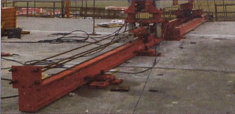
Figura N°2.12: Fotografía de carril de avance, instalado sobre dovela 0.
