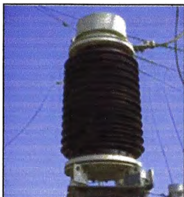
Figura N° 1.5. Transformador de tensión.
