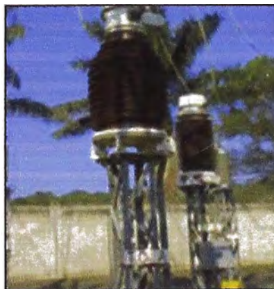
Figura N° 1.4 Transformador de corriente.
