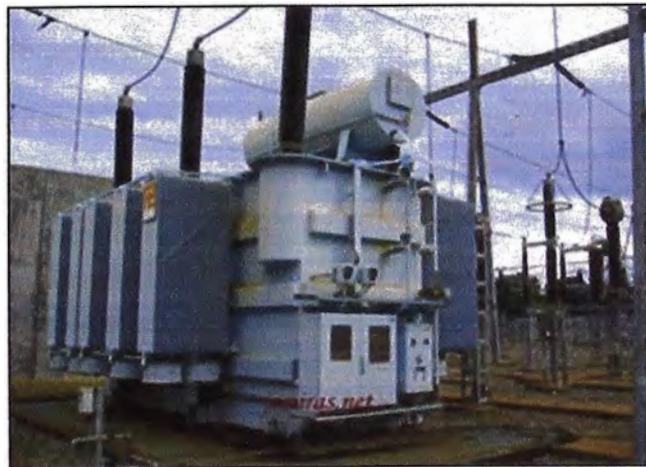
Figura N° 1.1 Transformador de potencia.
