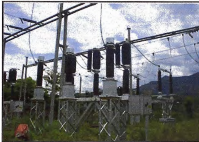
Figura N°1.2 Interruptores de potencia.
