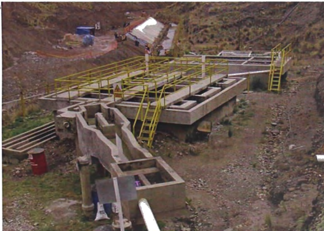
Gráfico N° 1.10 Sistema de Tratamiento de Aguas Servidas mediante Tanque Imhoff Fuente: Manual para Municipios Ecoeficientes –Ministerio del Ambiente
