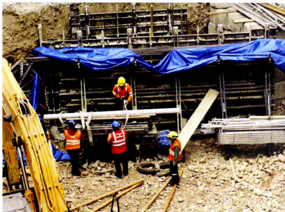
Figura 4.8 Mano de obra en apoyo de acarreo de materiales, en el desarrollo de la excavación masiva
