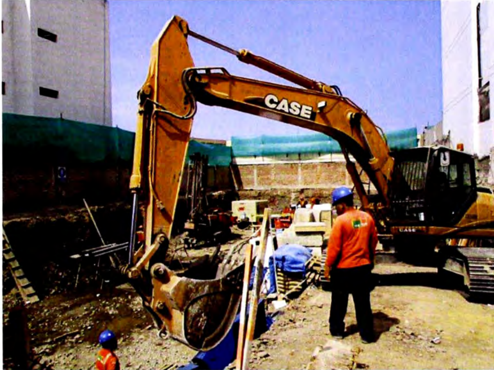
Figura 4.4 Movimientos de excavadora, al fondo se observa equipo de perforación y compresora neumática.
