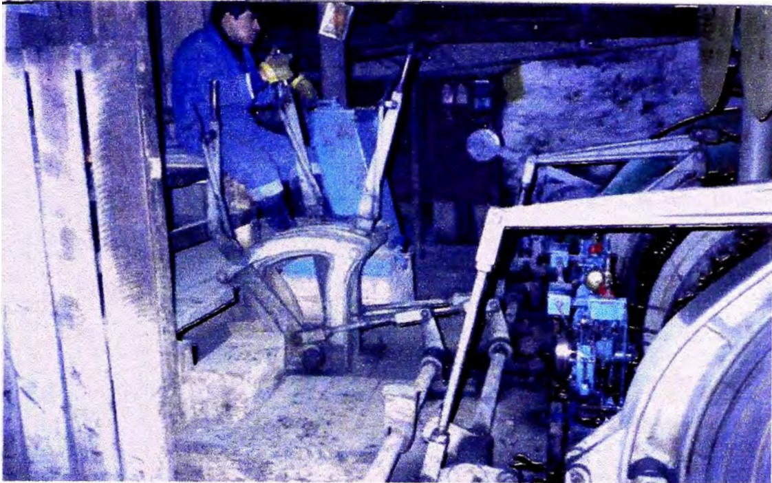
WINCHERO OPERANDO CONTROL DE MARCHA Y VARILLAJE DE FRENO
