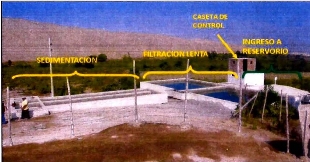
Fotografía N° 2.7: Planta de tratamiento de agua
