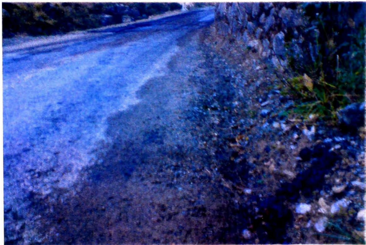
Figura N° 4.6, Residuos de asfalto en progresiva 186 +400.
