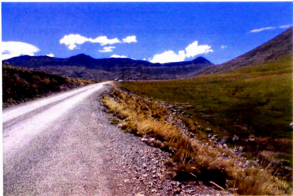
Figura N° 4.8, Vertimiento de líquidos a la cuneta en km 190+000.
