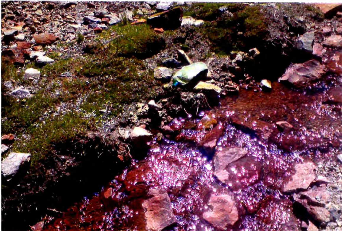
Figura N° 4.9, Cuneta que conduce líquidos que dejan sedimentos rojizos en la roca, obsérvese botella plástica, km 190+000.
