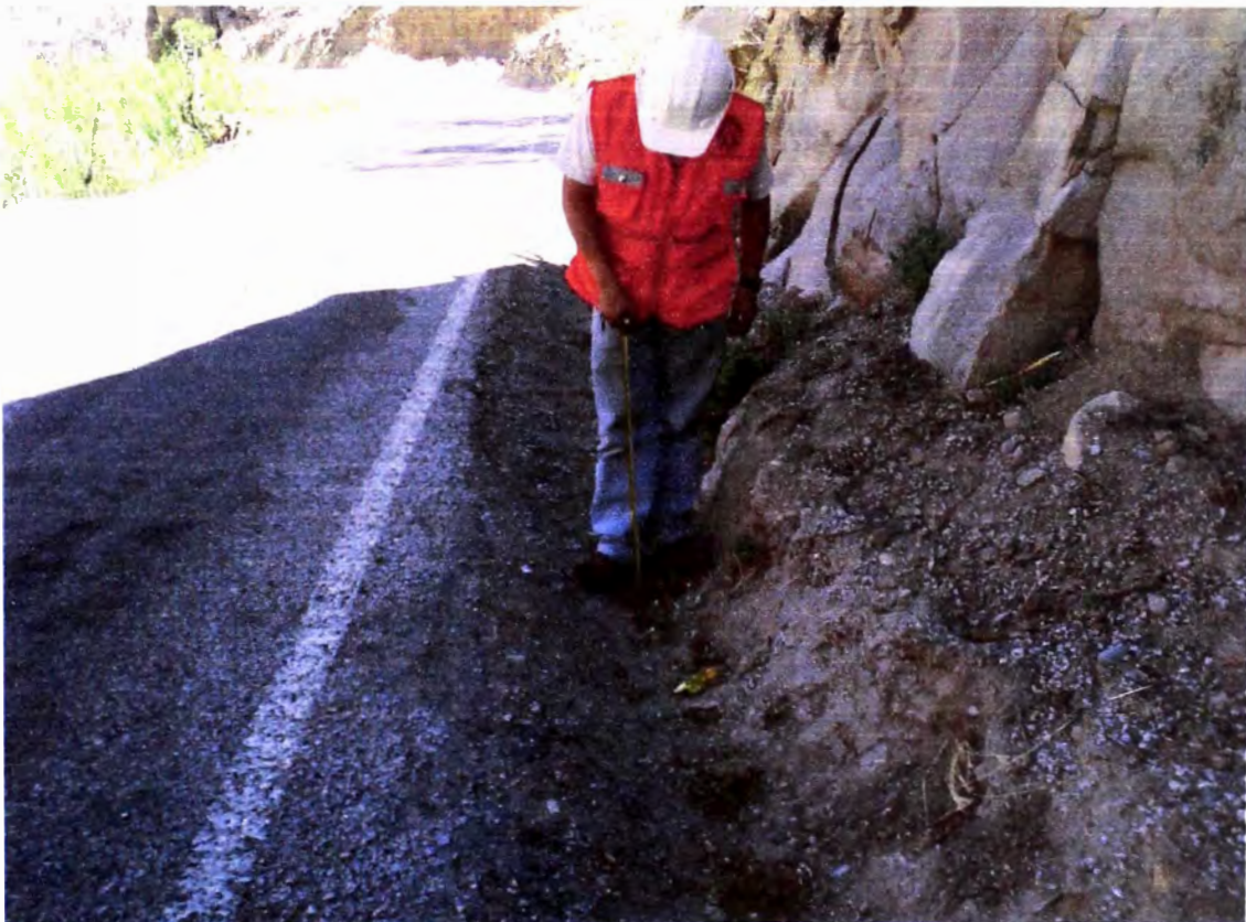
Fotografía 4.18 Cuneta en terreno natural, sin mantenimiento
