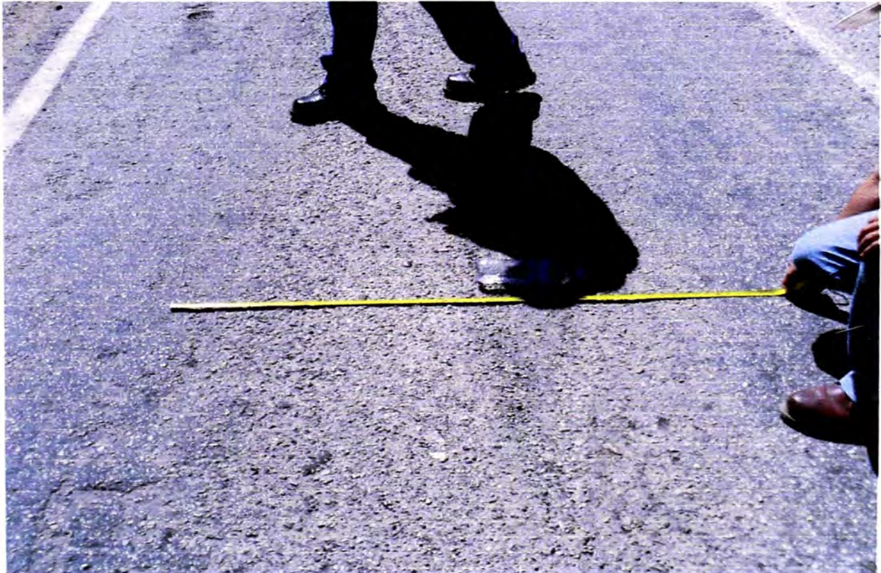
Fotografía 4.12 Desprendimiento de la gravilla en la superficie de rodadura
