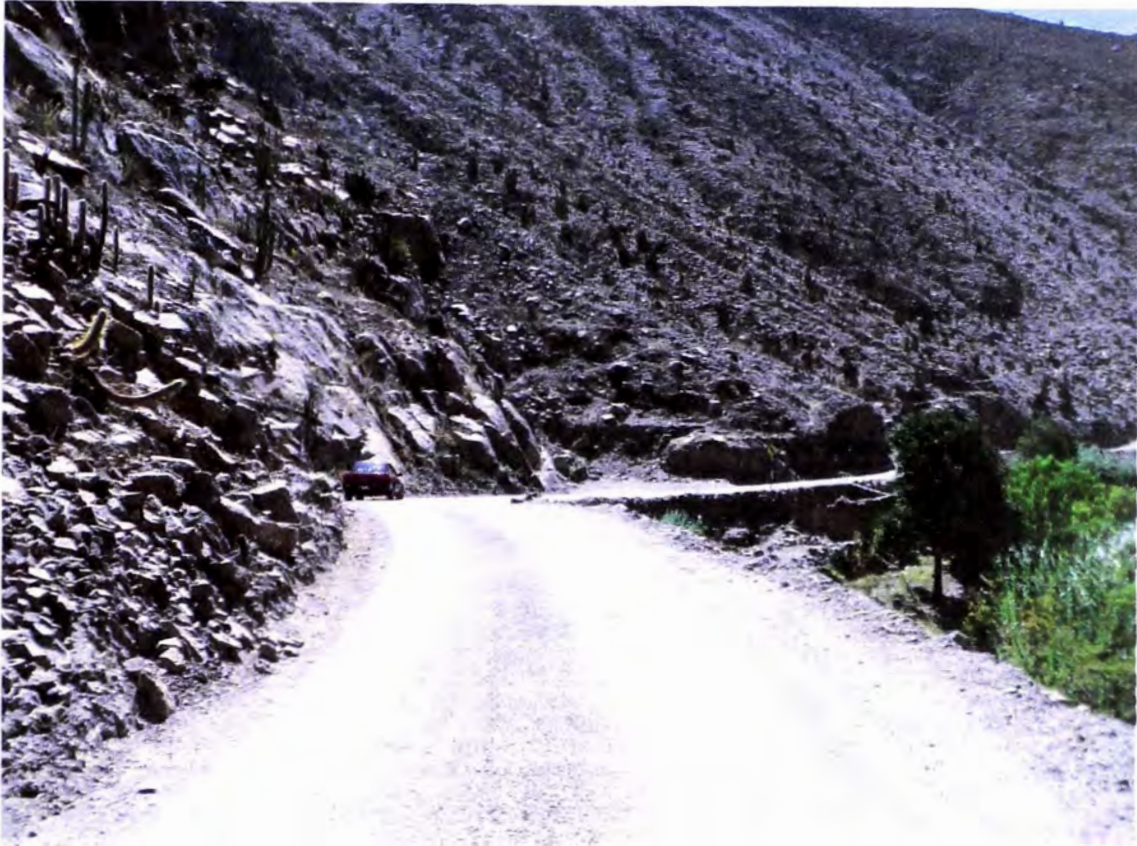
Fotografía 4.17 Sistema de drenaje inexistente
