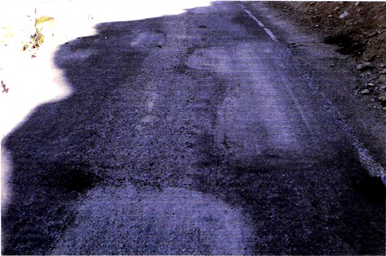
Fotografía 4.19 Parchado en frío de oquedades - deficiente
