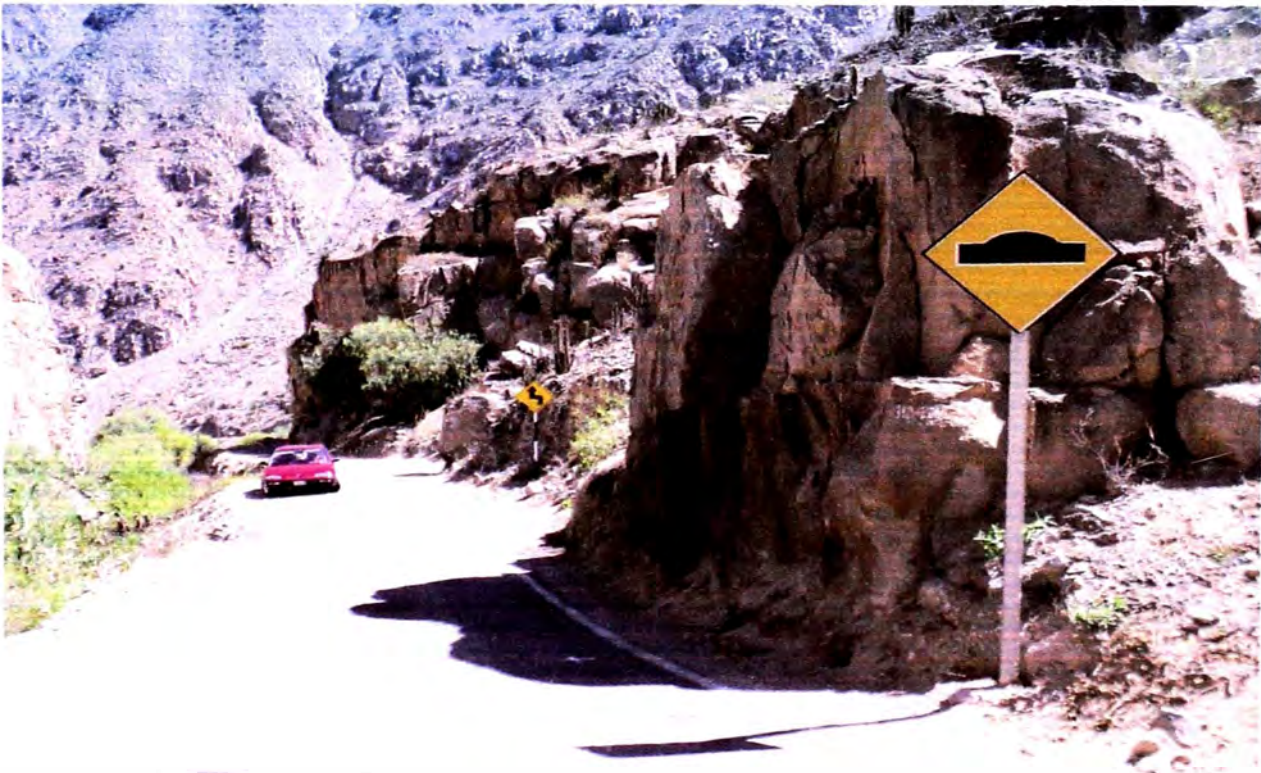
Fotografía 4.22 Seguridad vial, excesiva presencia de curvas, contracurvas y ojivas lo que acelera el proceso de desgaste de la superficie de rodadura
