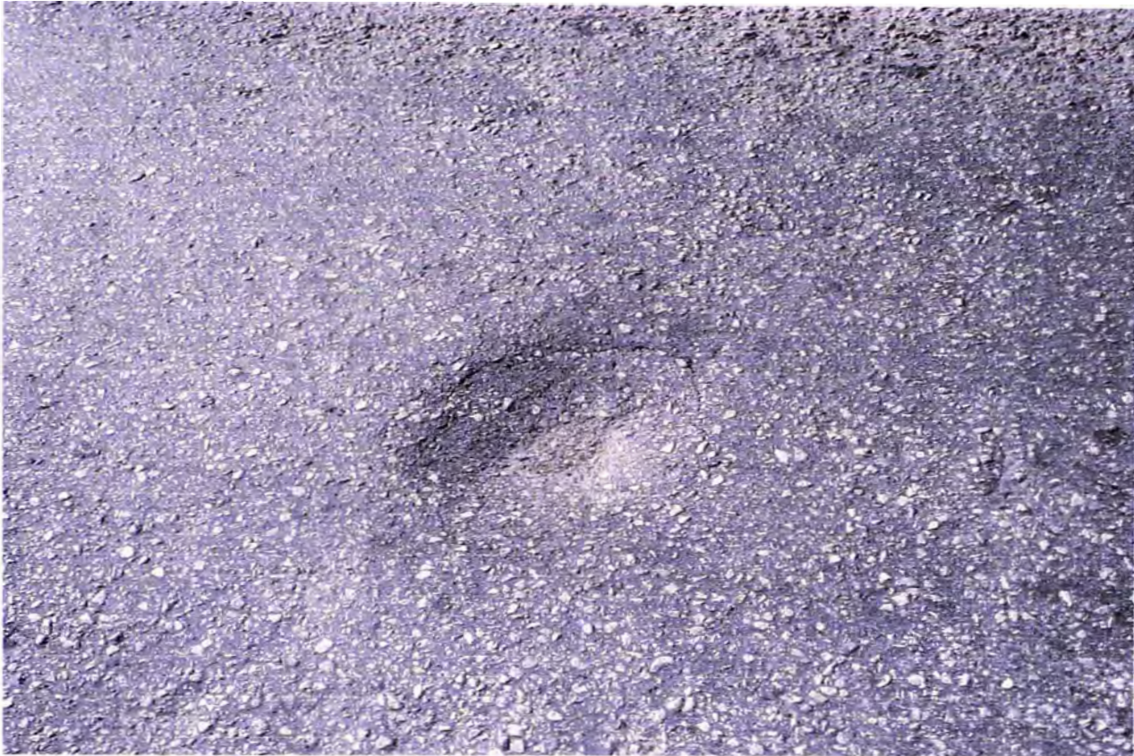
Fotografía 4.05 Hundimiento en el pavimento
