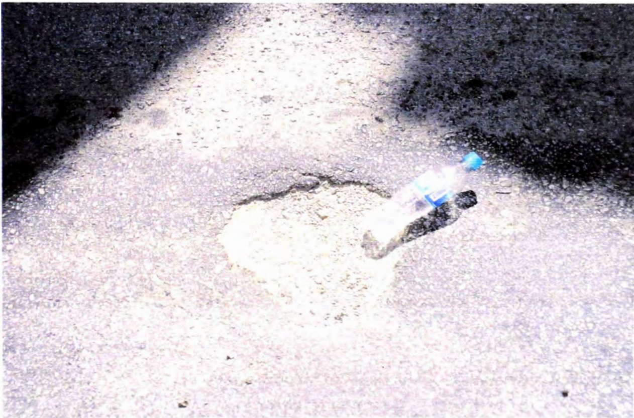
Fotografía 4.14 Oquedades en la superficie de rodadura
