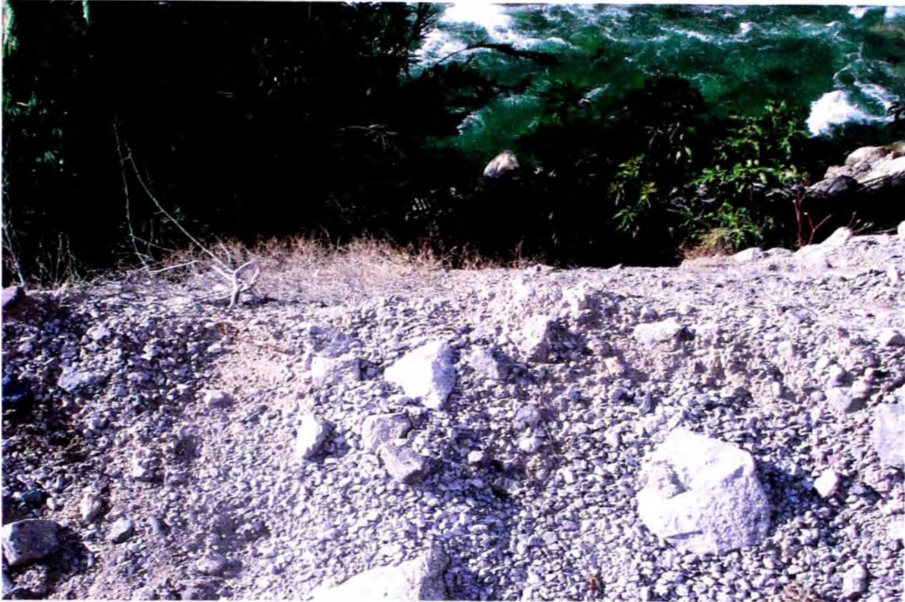
Fotografía 4.07 Erosión cercana a la vía
