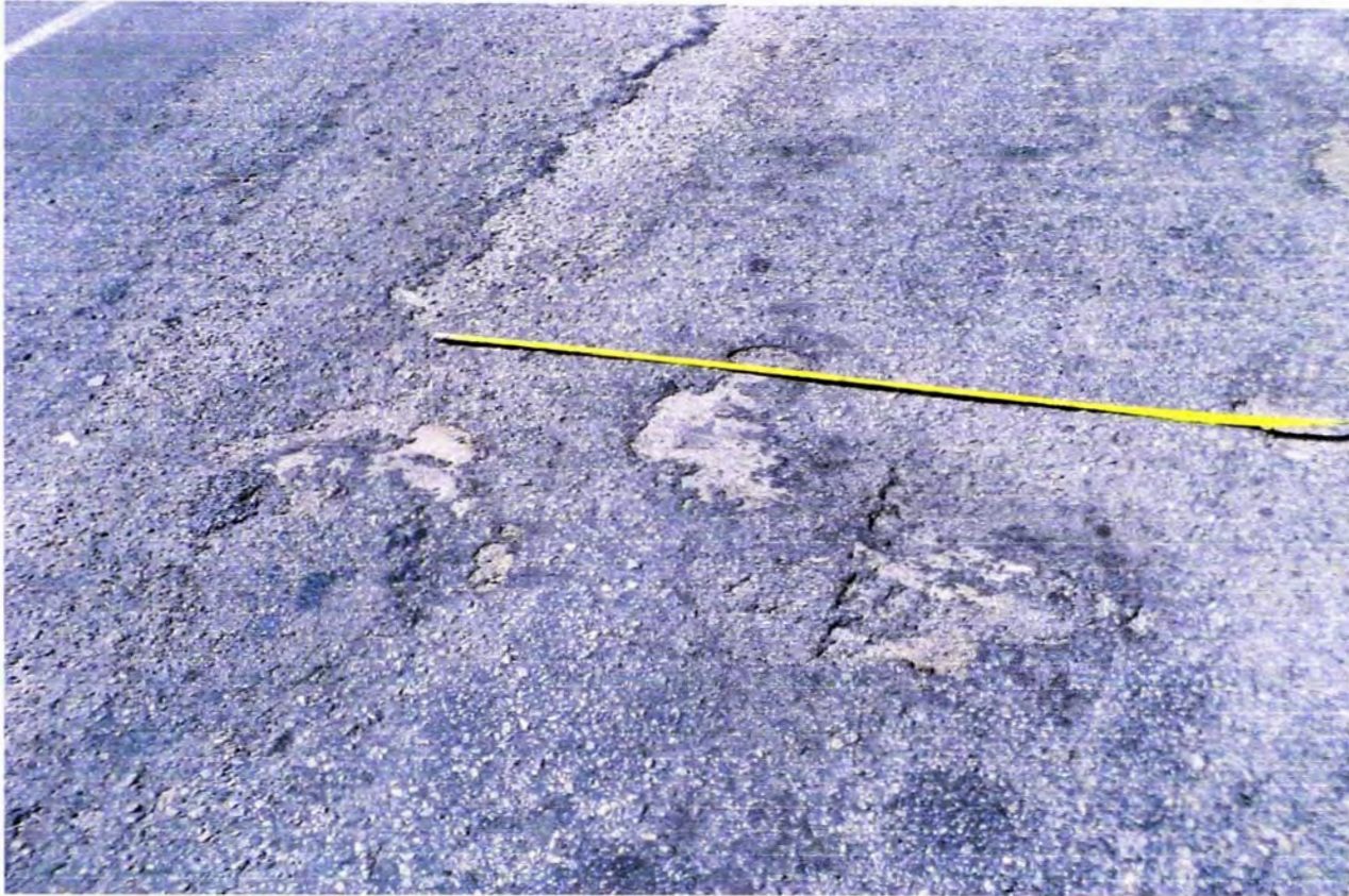
Fotografía 4.13 Desgaste acelerado de la superficie de rodadura
