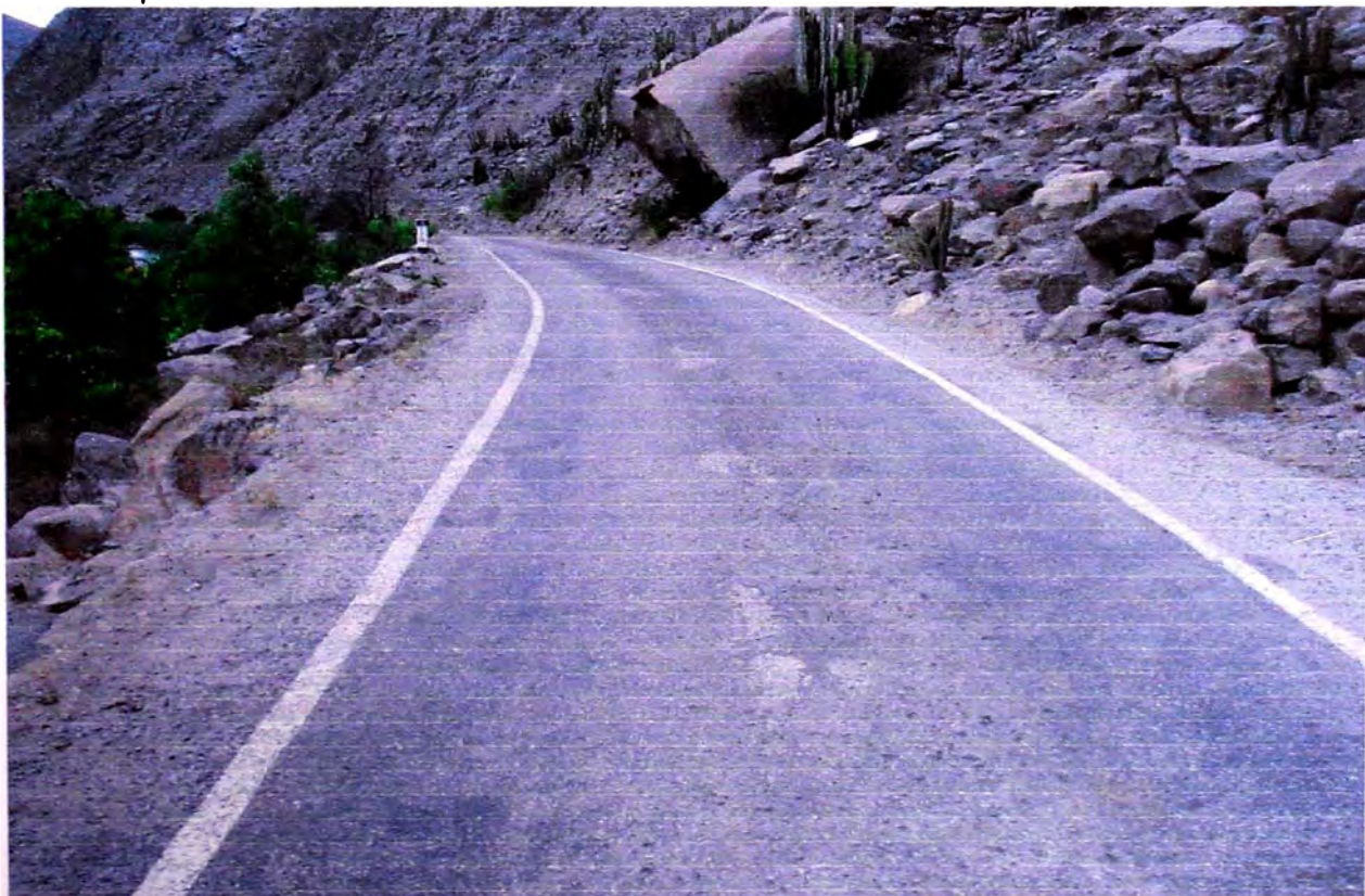
Fotografía 4.02 Superficie de rodadura en proceso de desgaste posiblemente por el aumento de tráfico, acumulación de agua y/o geometría variable.
