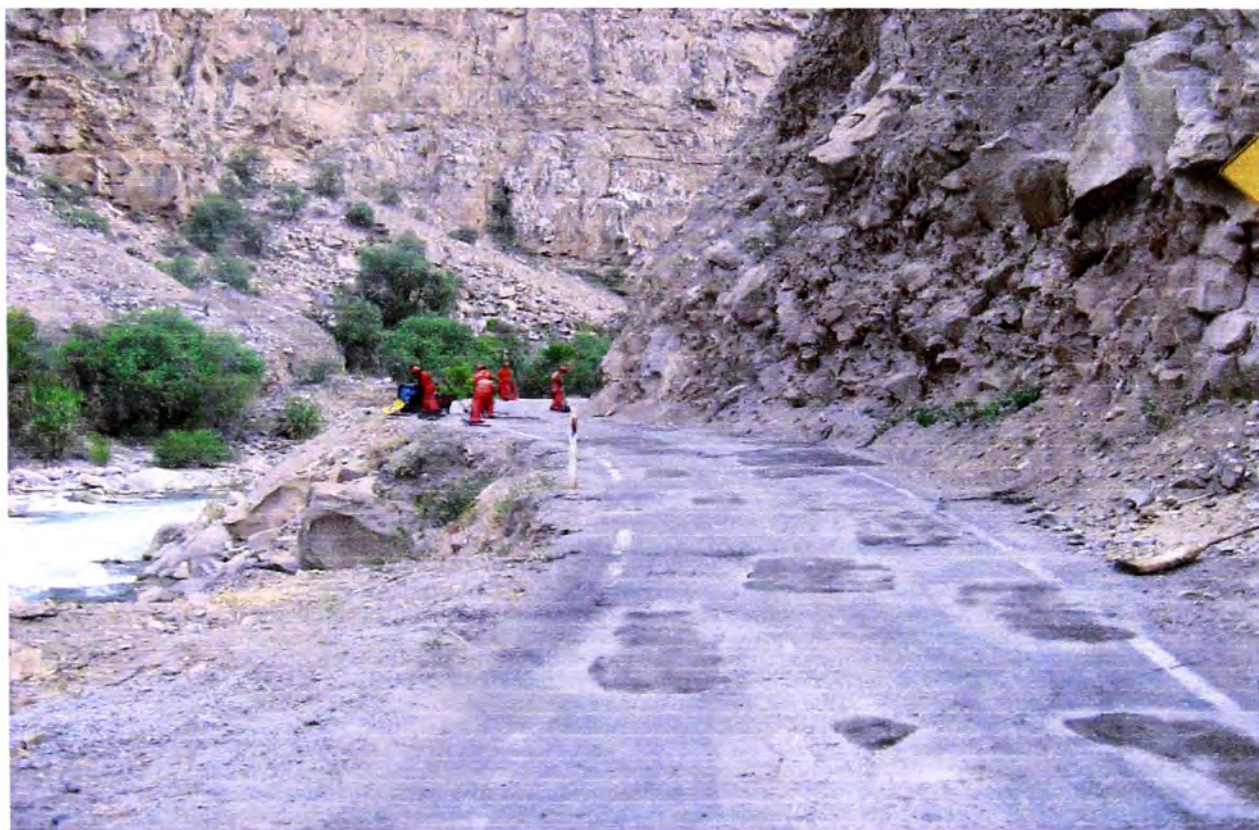
Fotografía 4.20 Parchado en frío de oquedades - deficiente
