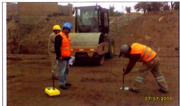
Foto N° 4.47.- Control de Densidad de Campo realizado por el método Densímetro Nuclear.
