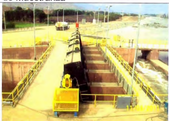
FOTO N°7.4.- Equipo de la Ventana de Toma y Rejillas
