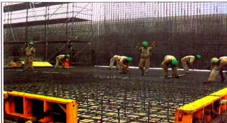
Foto N° 3.26.- Colocación del acero habilitado en el losa de la Poza de Disipación.
