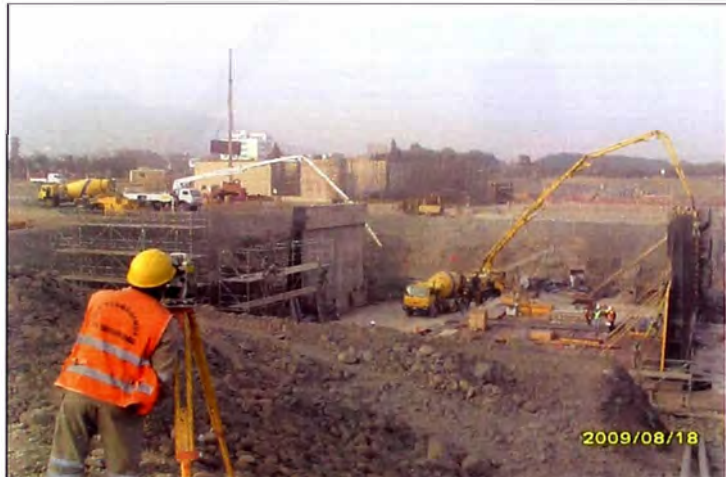
Foto N° 3.29.- Verificación de la verticalidad del muro en pleno vaciado de concreto en la Poza de Disipación.
