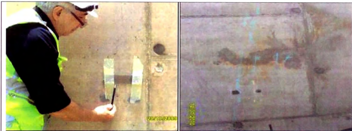
Foto N° 6.50.- Reconocimiento de la fisura por la Supervisión.
