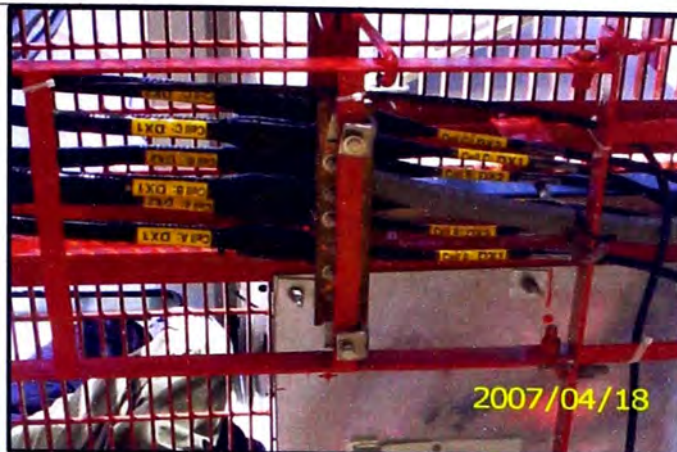
Figura 31.- Bornera en plataforma de descaso intermedio de la torre
