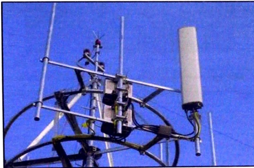
Figura 22.-Soporte de antenas RF
