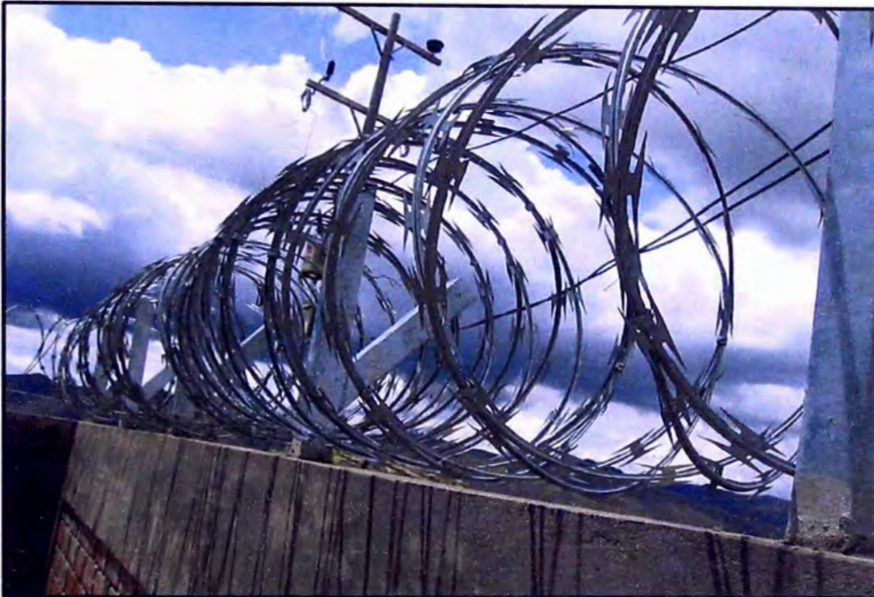
Figura 16.- Vista de los soportes de concertina embebidos en el concreto de la viga DESENCOFRADO
