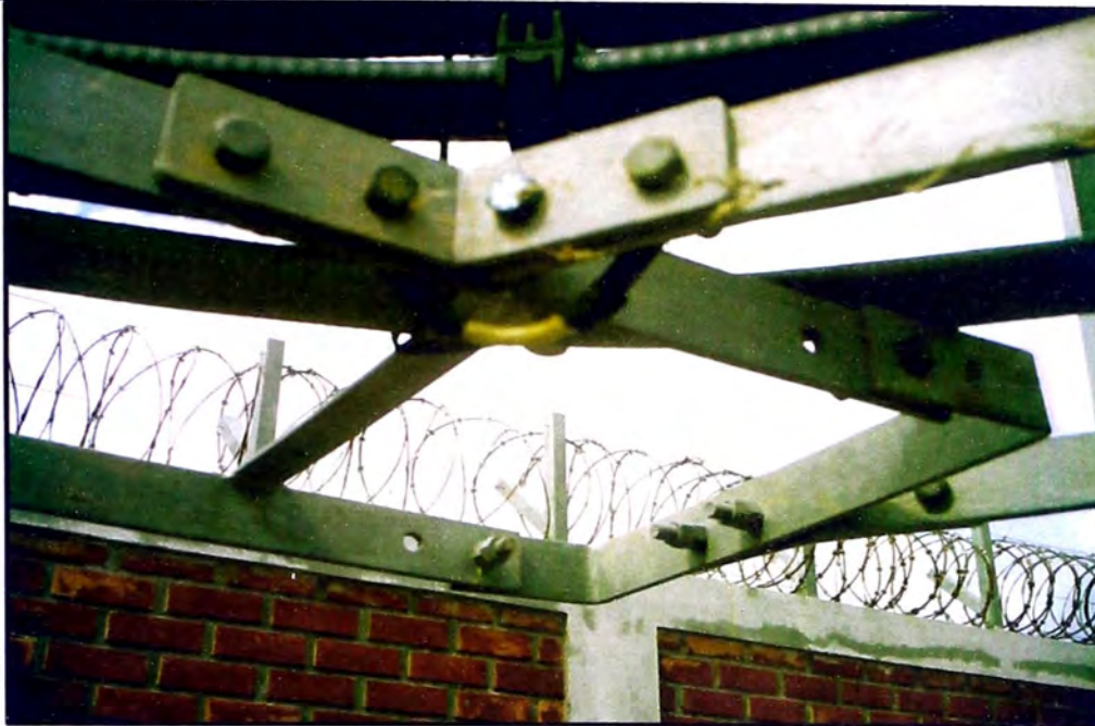
Figura 29.- Jumper en escalera Rack
