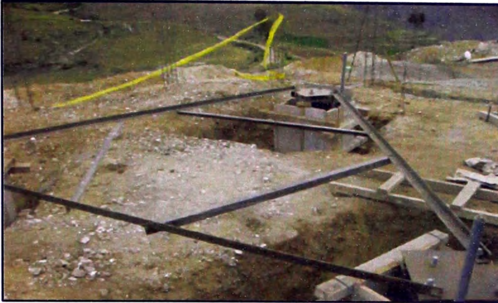
Figura 18.- Vista de plantilla metálica (EBC Cabanaconde)
