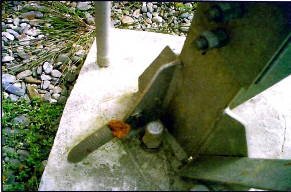
Figura 27.- Aterramiento de bases metálicas de la torre.
