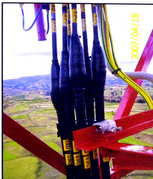
Figura 32.- Empalme split de cableado de conexiones
