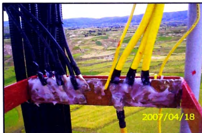
Figura 30.- Bornera para conexiones de aterramientos
