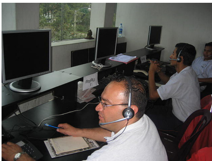
Figura 3.5.6H: Centro de Control de Comunicaciones
