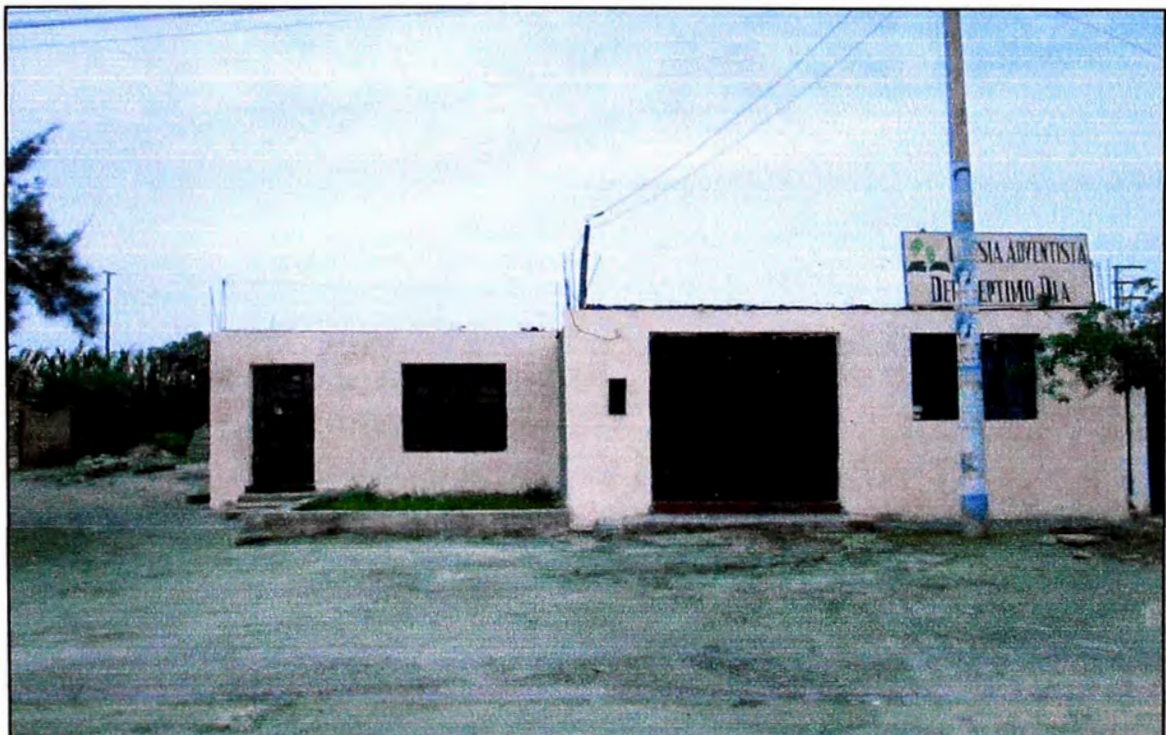
Figura 2.27. Edificación de albañilería de arcilla en estado de conservación regular. Mz "95" Lt "3".
