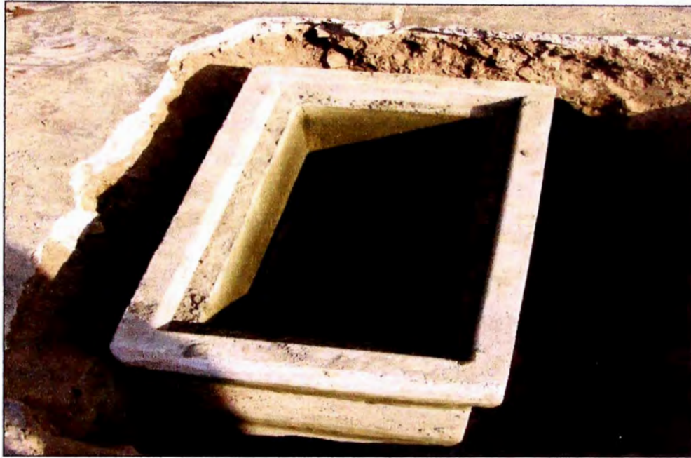
Figura N°4.3 CAJA DE REGISTRO.
