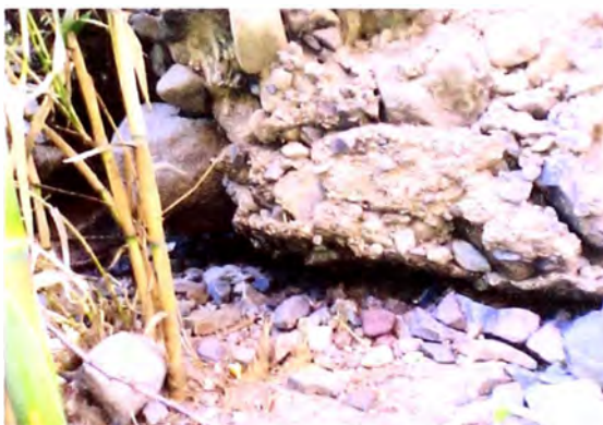
Foto N° 14: (Socavación en estribos)
