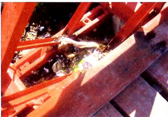
Foto N° 06: (Basura en estructura metálica)
