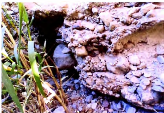
Foto N° 13: (Socavación en estribos)
