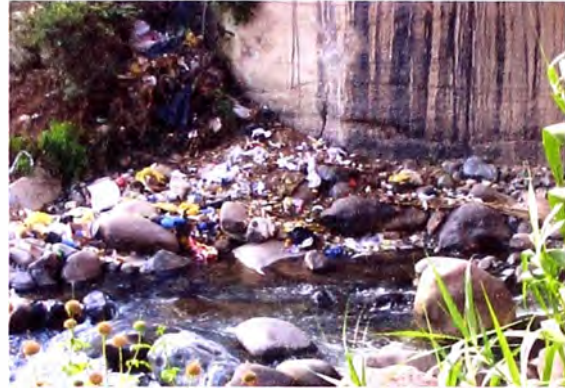
Foto N° 05: (Basura en los estribos)
