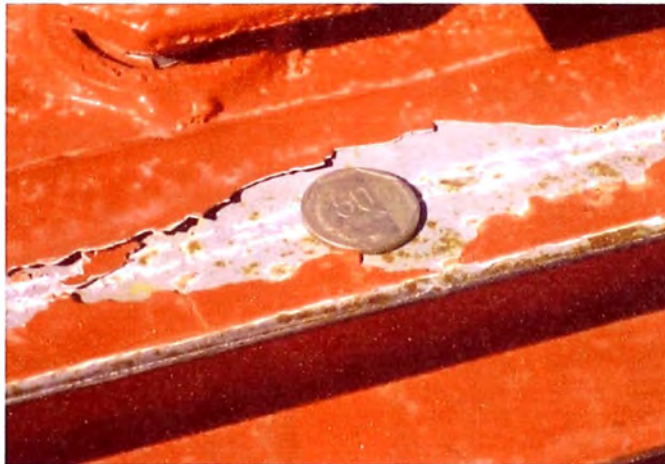
Foto N° 10: (Pintura en mal estado)
