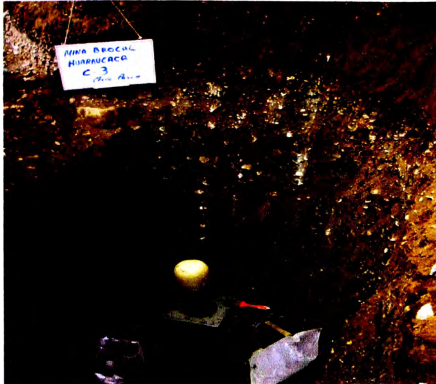
Foto N° 09: Vista del interior de la Calicata C-3 y ensayo de densidad In-situ
