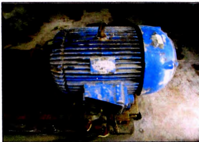
Figura N° 06: Motor de impulsión de la estación Las Lagunas
