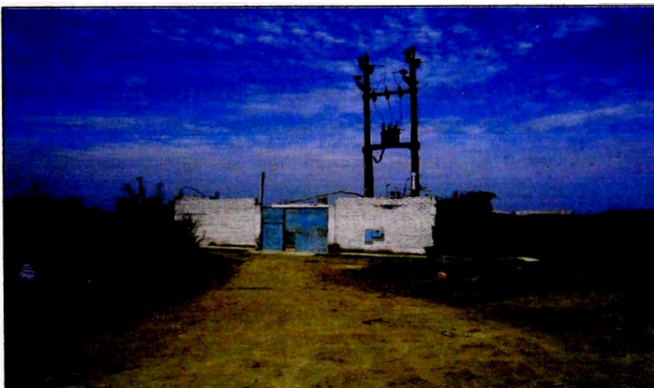
Figura N° 05: Estación de bombeo N° 01, "Las Lagunas".
