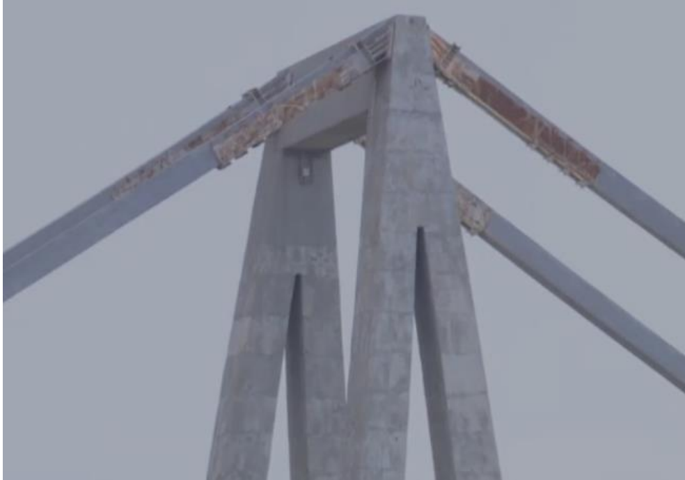
Figura 3 Estructura del puente Morandi evidencia una agresiva corrosión por la niebla salina y por ataque químico
