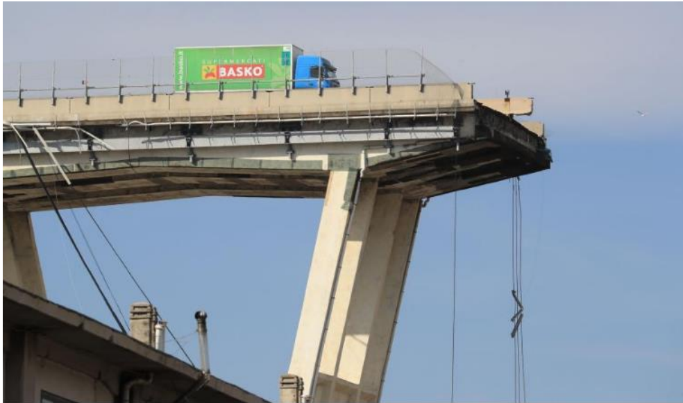
Figura 4. Colapso de la estructura del puente Morandi
